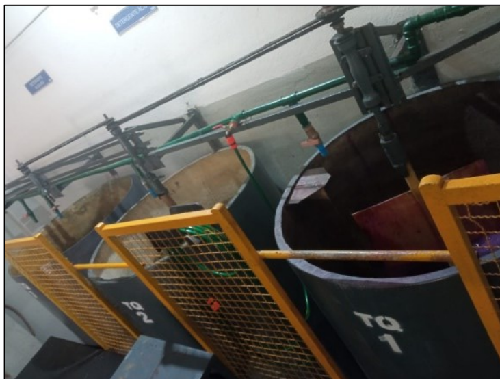
Figura 19 – Disposição e arranjo dos tanques na empresa.
