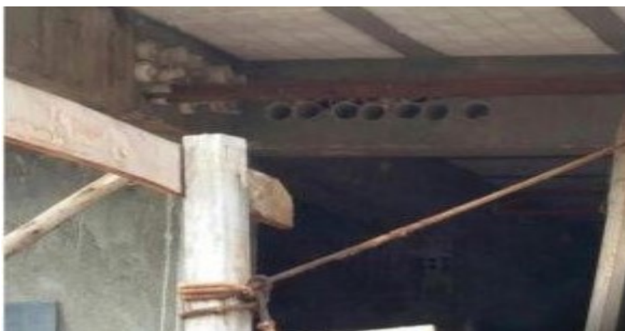
Figura 26 – Tubulação instalada de maneira inadequada.
