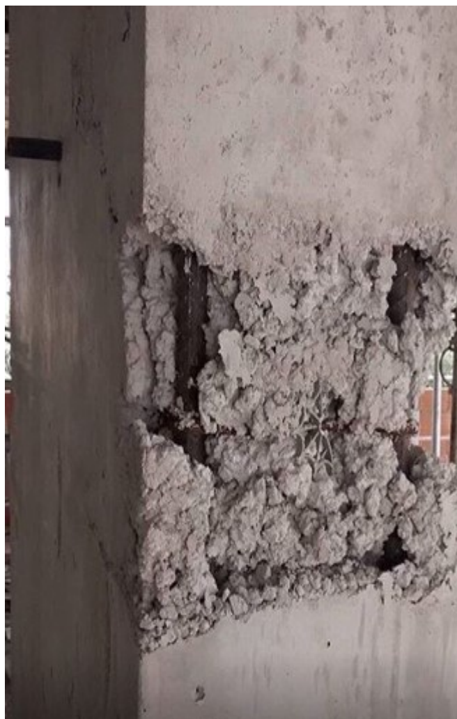
Figura 16 – Segregação em Pilar de Concreto.
