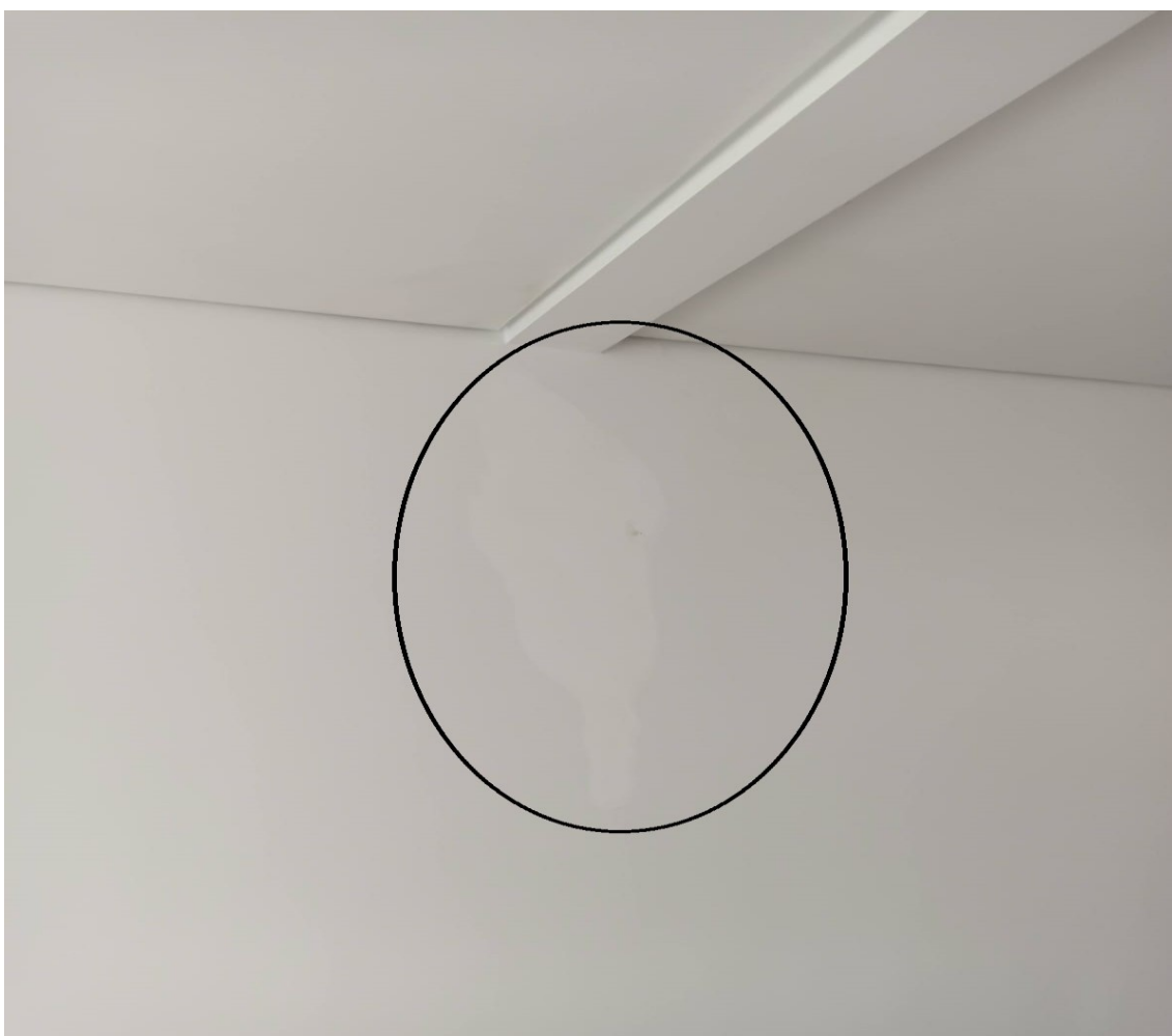
Figura 14 – Patologia em pintura na alvenaria.
