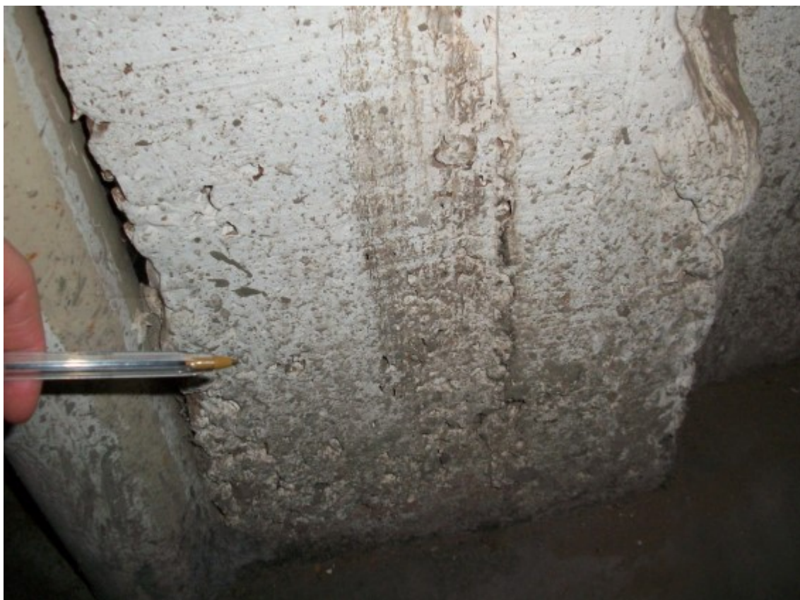
Figura 6 – Segregação do concreto na base do pilar.
