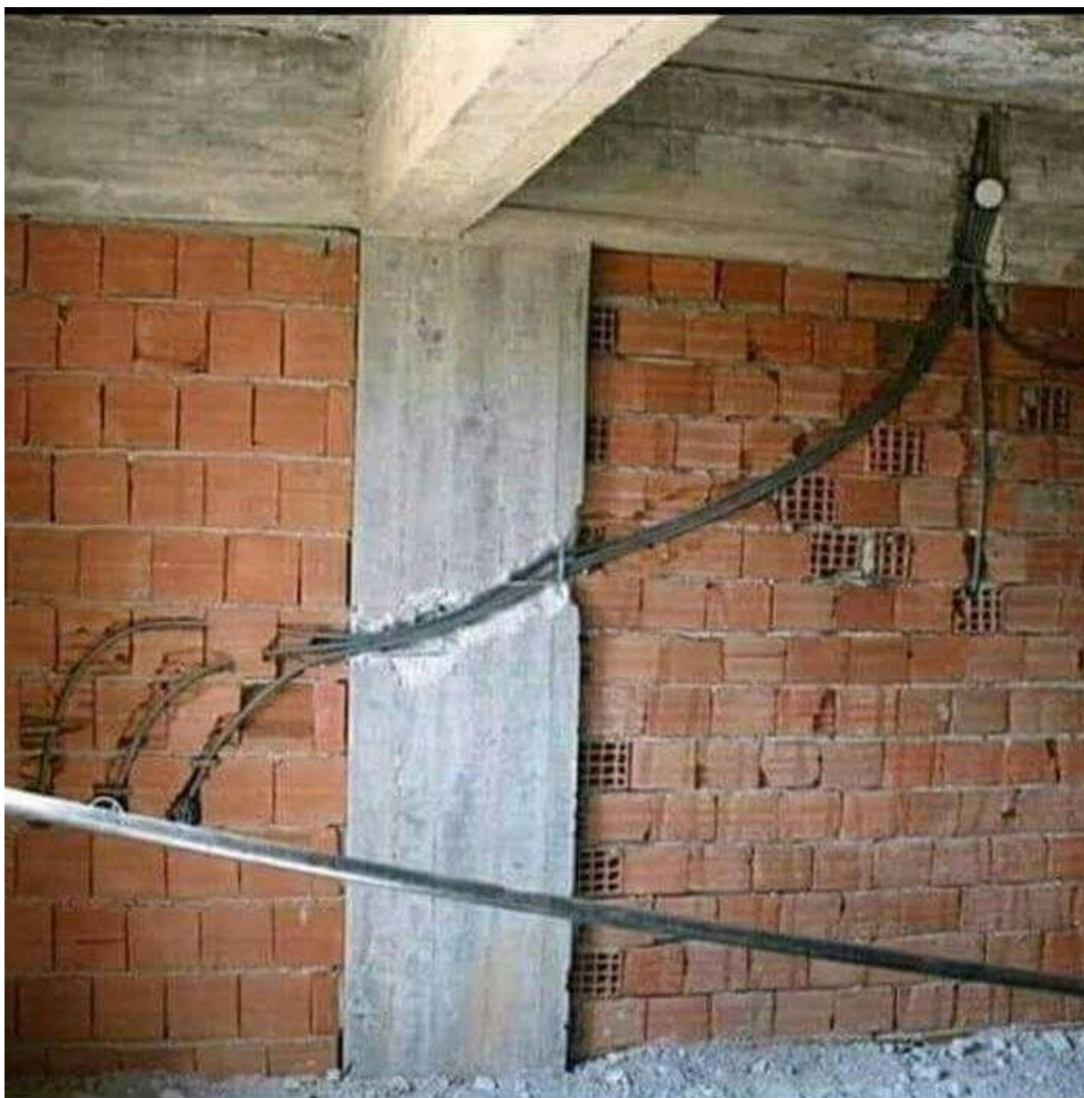
Figura 32 – Incompatibilidade de pilar com projeto elétrico.
