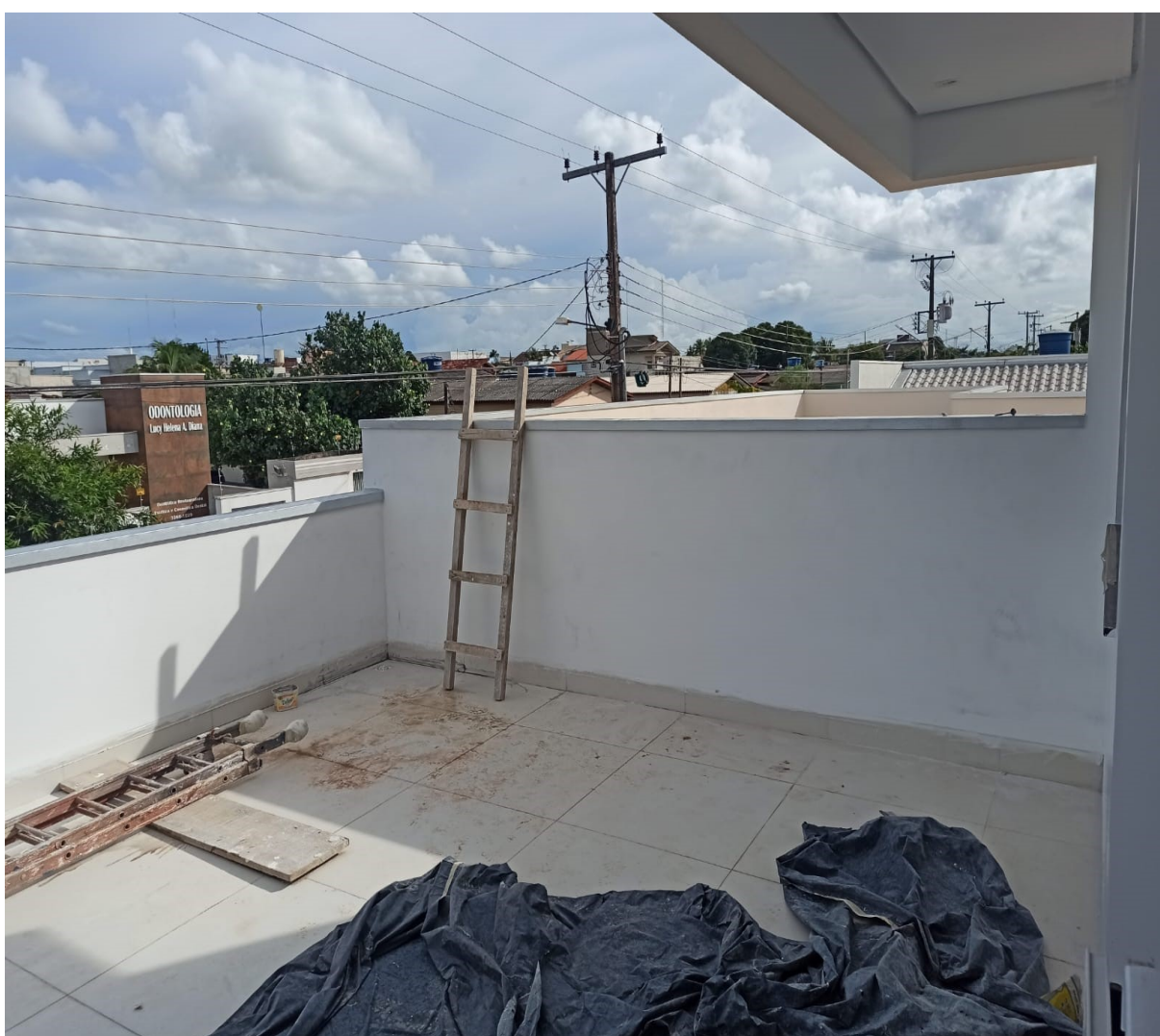
Figura 18 – Sacada não impermeabilizada.
