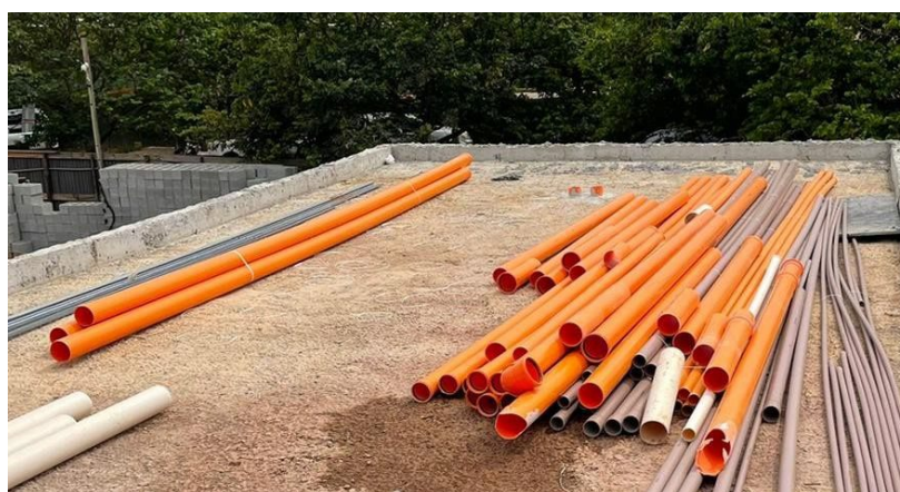
Figura 10 - Armazenamento de tubulação para água quente em PVC
