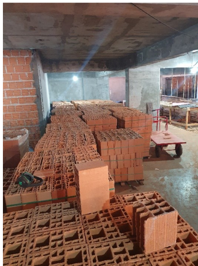
Fotografia 1 - Blocos cerâmicos diversos dispostos em lugar inadequado
