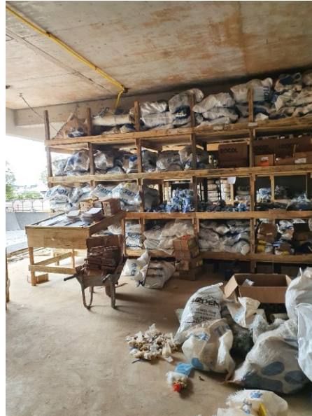
Fotografia 65 - Armazenamento de material hidráulico antes da mudança
