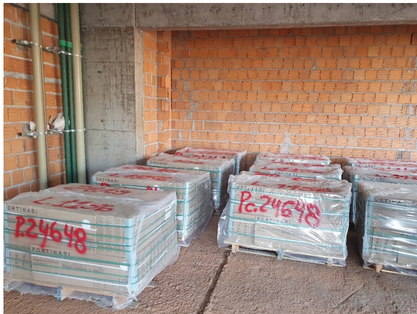
Fotografia 14 - Armazenamento de materiais (2)
