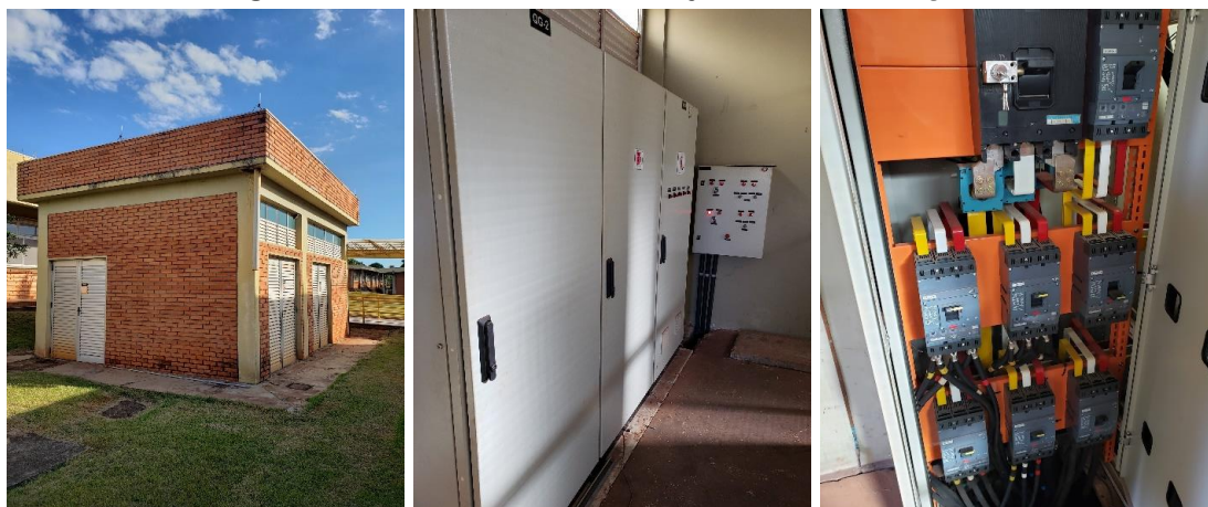
Figura 6 – Painéis metálicos e disjuntores subestação 2
