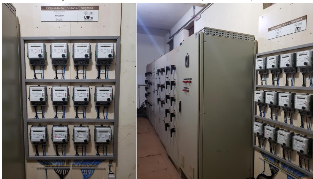
Figura 14 – Painel instalado na subestação 1 do campus
