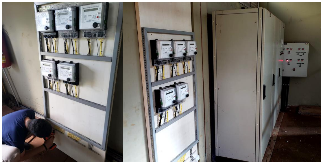
Figura 13 – Instalação dos 5 medidores na Subestação 2 do campus
