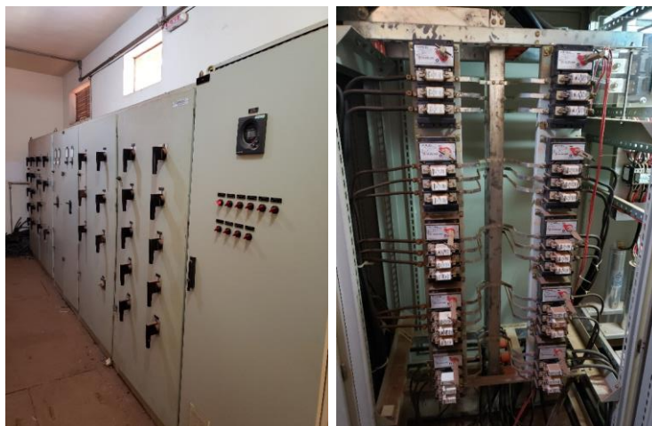
Figura 5 – Painéis metálicos e fusíveis subestação 1
