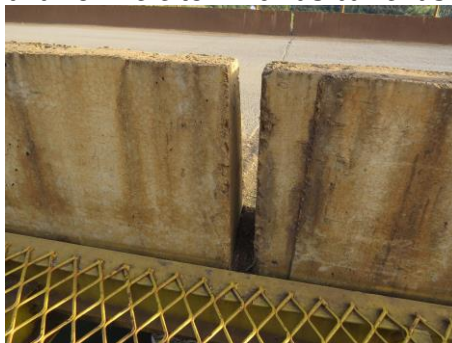
Fotografia 13 - Defeito 1120 nas barreiras rígidas
