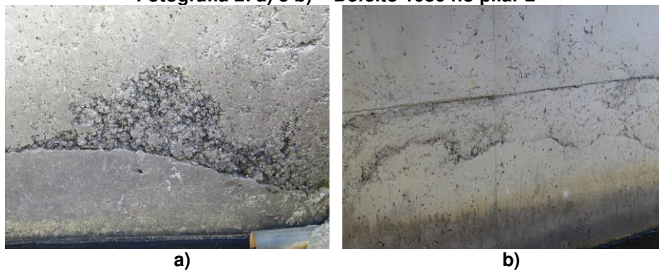
Fotografia 2: a) e b) – Defeito 1080 no pilar 2
