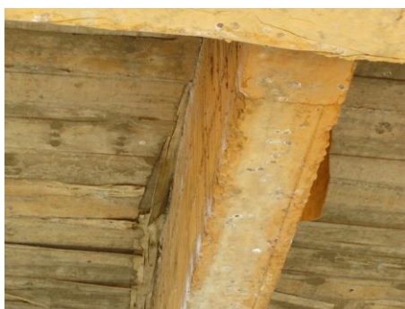
Fotografia 8 – Defeito 1090 nas vigas transversinas
