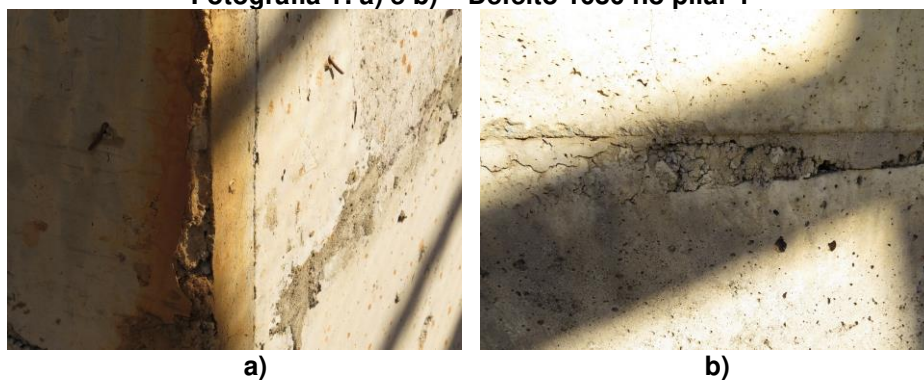
Fotografia 1: a) e b) – Defeito 1080 no pilar 1
