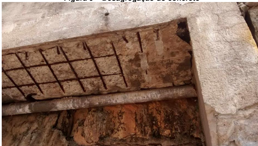
Figura 9 – Desagregação do concreto
