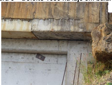
Figura 6 – Defeito 1080 na laje em balanço 1
