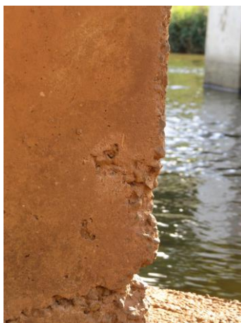
Fotografia 3 – Defeito 1080 no pilar 3
