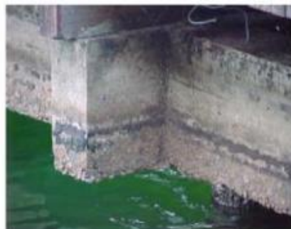
Fig. 15 - Desagregação do concreto ( F_i=3 )
