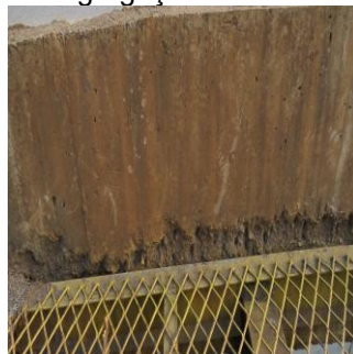
Desagregação do concreto
