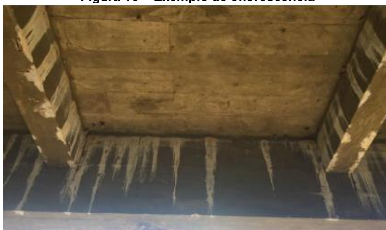
Figura 10 – Exemplo de eflorescência
