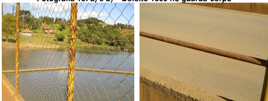
Fotografia 16: a) e b) – Defeito 1000 no guarda-corpo
