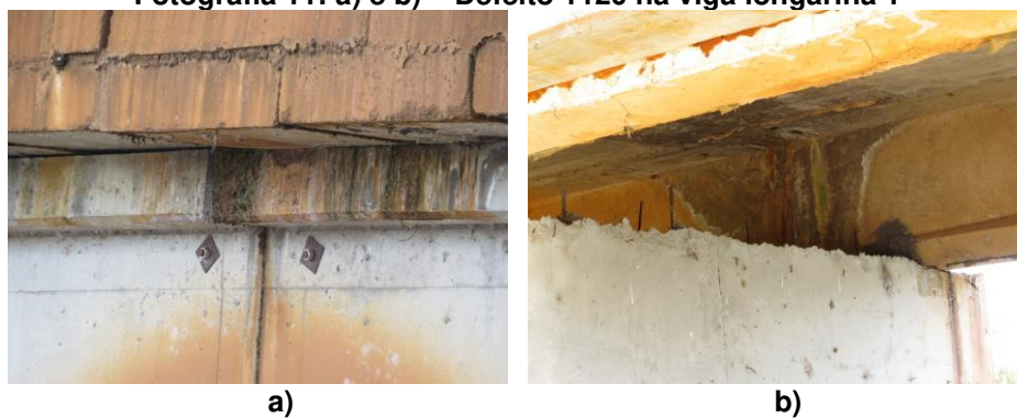
Fotografia 11: a) e b) – Defeito 1120 na viga longarina 1
