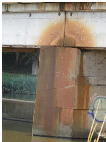
Fotografia 10 – Defeito 1120 no pilar 1
