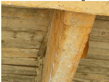
Fotografia 12 – Defeito 1120 nas vigas transversinas
