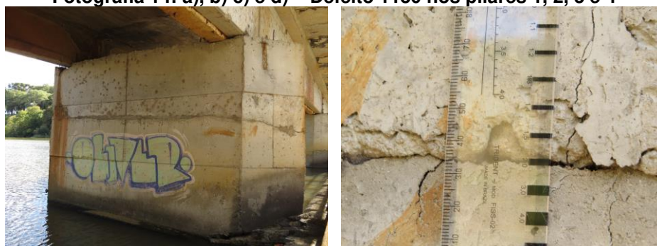
Fotografia 14: a), b) c) e d) – Defeito 1130 nos pilares 1, 2, 3 e 4
