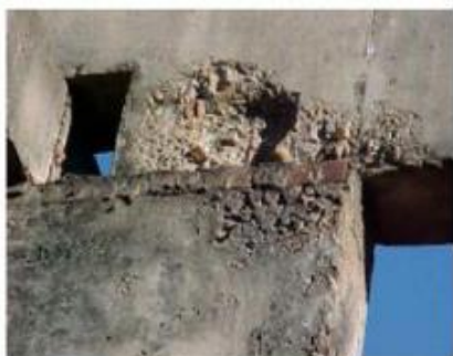
Fig. 12 - Desagregação do concreto na viga ( F_i=4 ) e Falha de concretagem no pilar ( F_i=1 )
