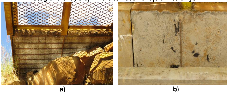
Fotografia 9: a) e b) – Defeito 1080 na laje em balanço 2
