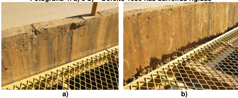
Fotografia 4: a) e b) – Defeito 1080 nas barreiras rígidas
