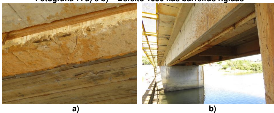
Fotografia 7: a) e b) – Defeito 1090 nas barreiras rígidas
