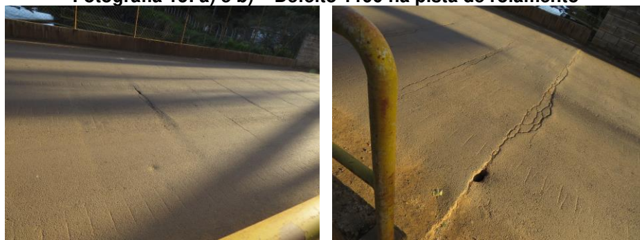
Fotografia 15: a) e b) – Defeito 1190 na pista de rolamento
