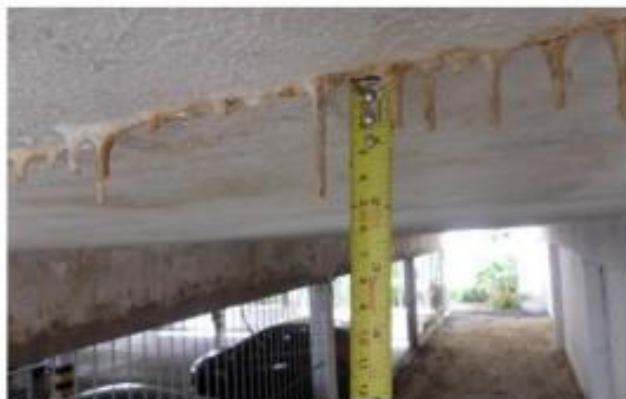
Figura 11 – Lixiviação com presença de estalactites
