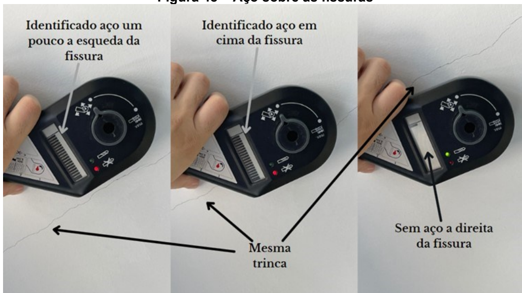
Figura 48 – Aço sobre as fissuras
