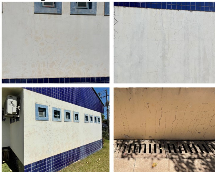
Figura 28 – Compilado de manchas e fissuras
