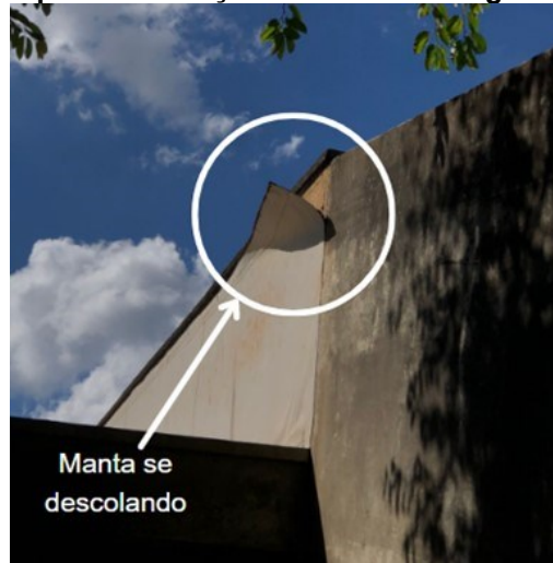
Figura 14 – Impermeabilização descolando no ginásio na UTFPR
