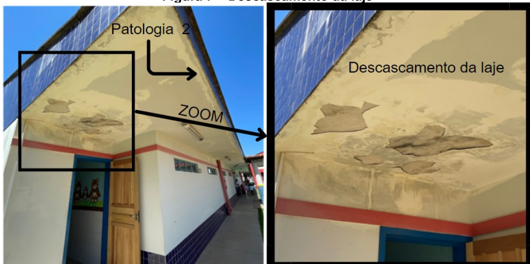
Figura 7 – Descascamento da laje
