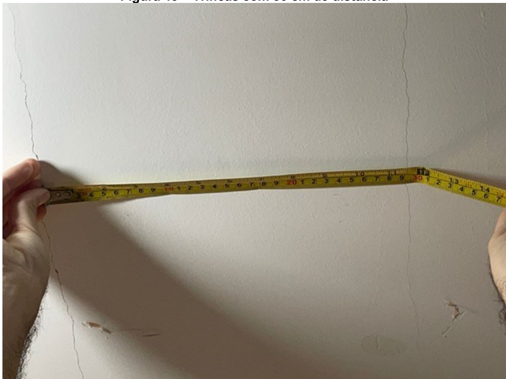
Figura 43 – Trincas com 30 cm de distância
