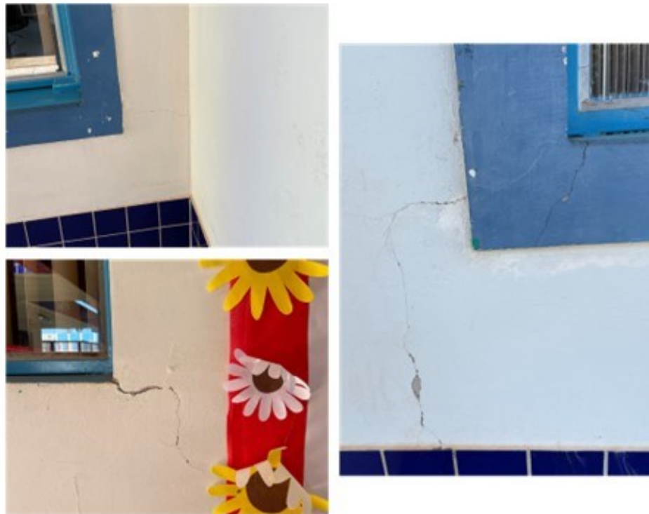
Figura 21 – Fissuras em janelas
