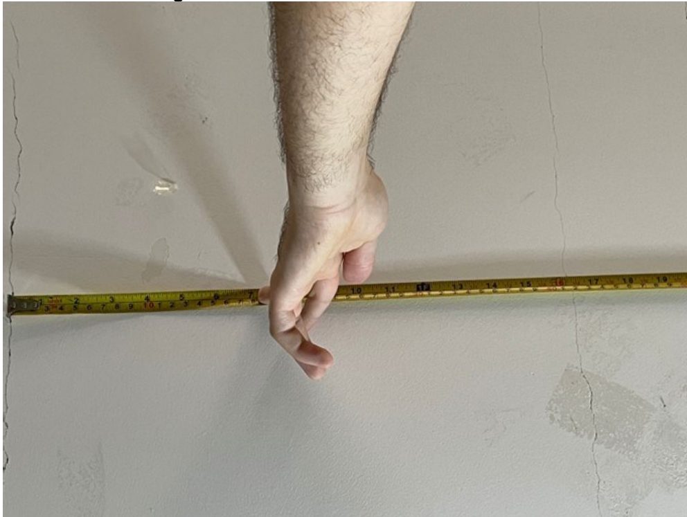
Figura 44 – Trincas com 42 cm de distância
