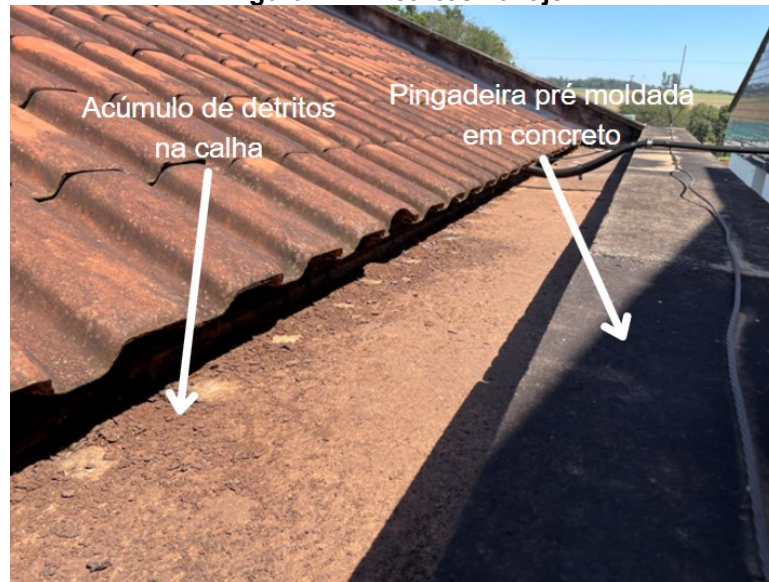
Figura 11 – Detritos na laje
