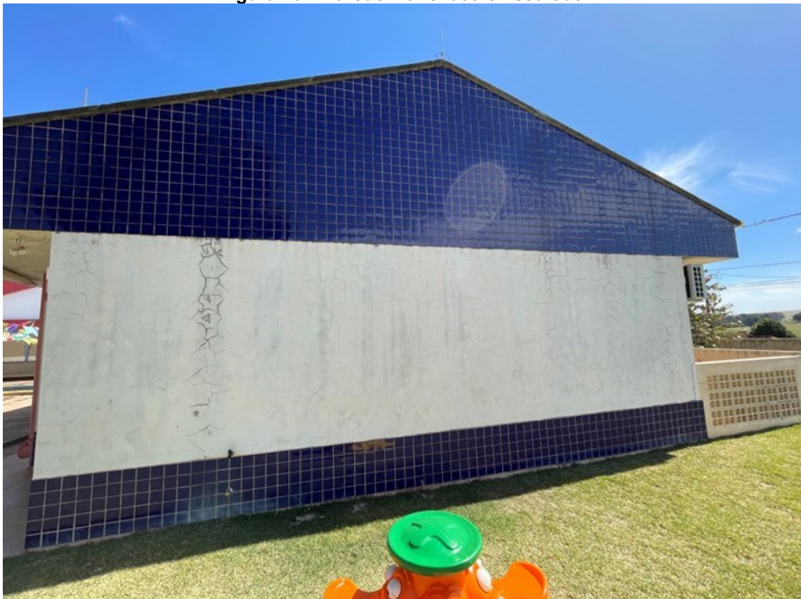
Figura 26 – Parede manchada e fissurada
