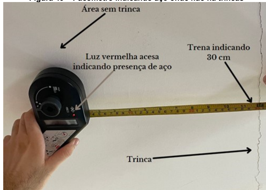
Figura 49 – Pacômetro indicando aço onde não há trincas
