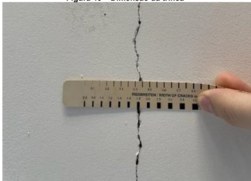
Figura 40 – Dimensão da trinca
