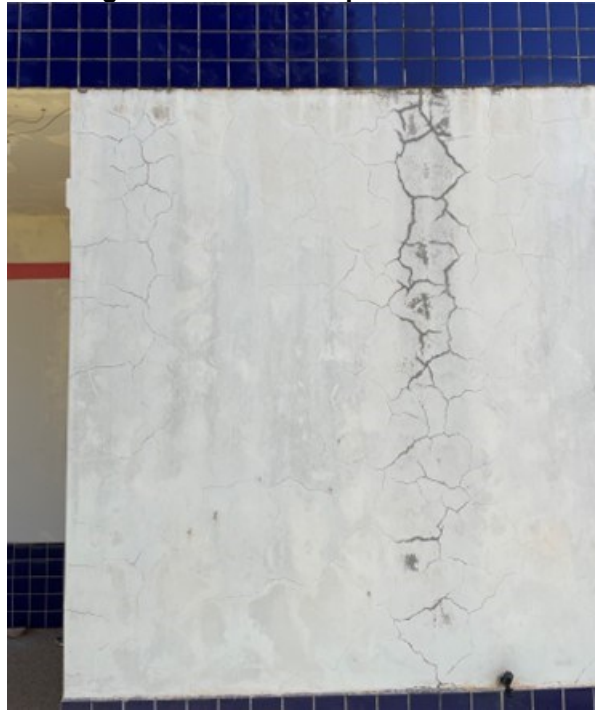
Figura 27 – Zoom na parede afetada
