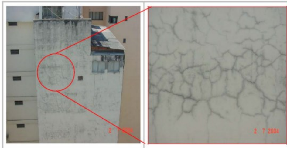
Figura 1 – Revestimento externo fissurado
