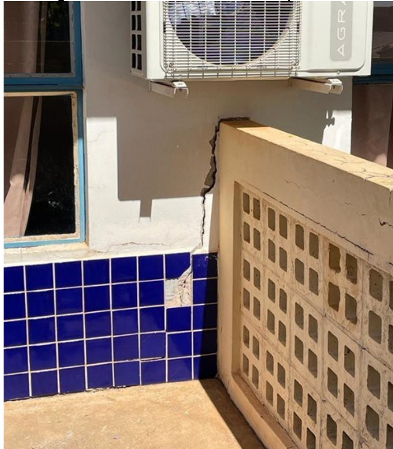
Figura 35 – Revestimento danificado pela trinca
