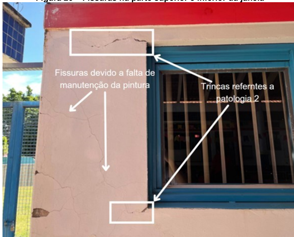
Figura 20 – Fissuras na parte superior e inferior da janela
