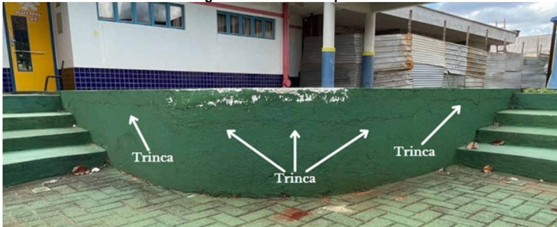
Figura 52 – Trinca no palco
