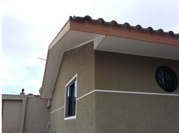
Figura 31 – Parede protegida por beiral
