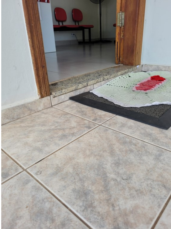
Fotografia 9 - Desnível na entrada da UBS Angelina Palon Oliva
