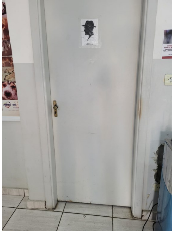
Fotografia 12 - Maçaneta da porta do sanitário da USF Luis Padilha de Oliveira
