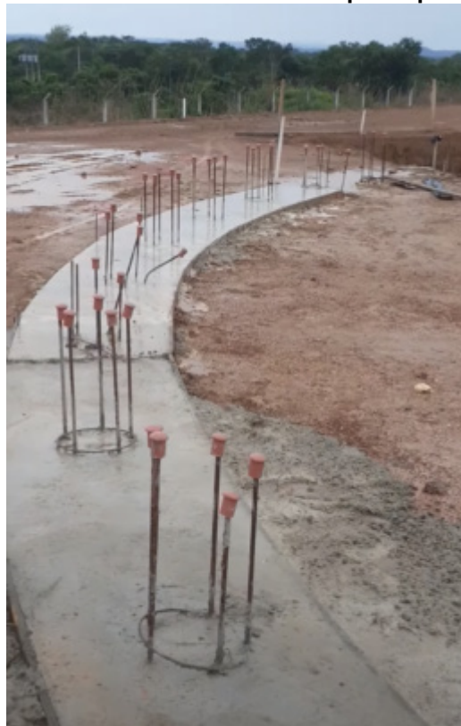
Figura 34 Anel de coroamento concretado com as esperas para o anel de base
