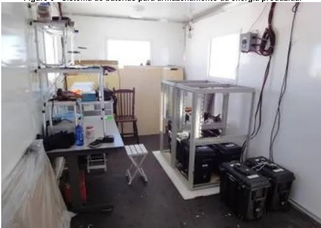
Figure 6 - Sistema de baterias para armazenamento da energia produzida.
