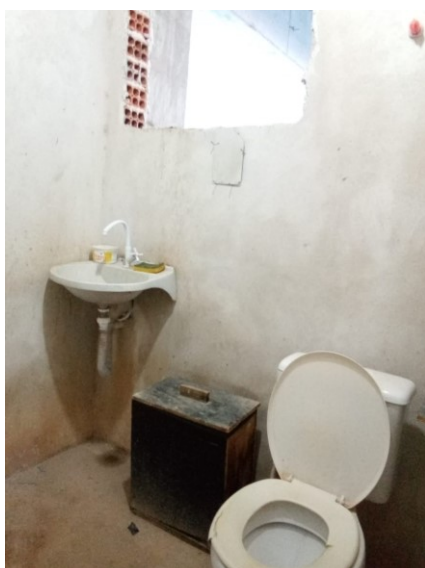
Figura 10 - Instalações Sanitárias da obra 2
