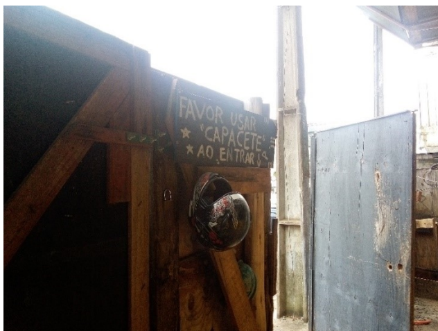
Figura 26 - Aviso para prevenção de acidentes na obra 3
