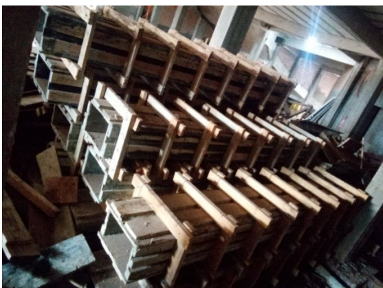
Figura 24 - Armazenagem de madeira na obra 3
