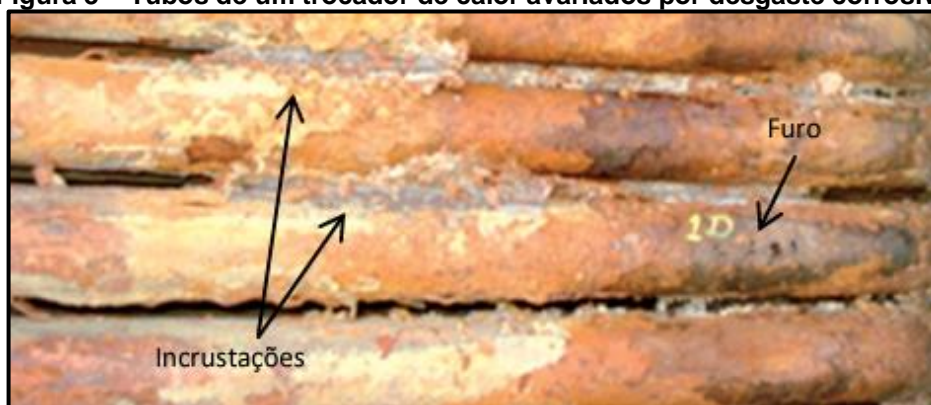
Figura 3 – Tubos de um trocador de calor avariados por desgaste corrosivo
