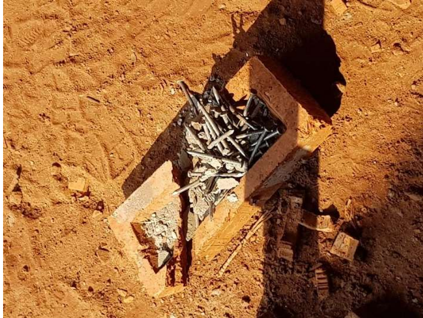
Figura 25 – Pregos das caixarias coletados num tijolo laminado.
