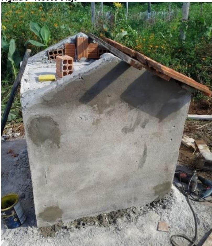
Figura 5 - reboco e laje
