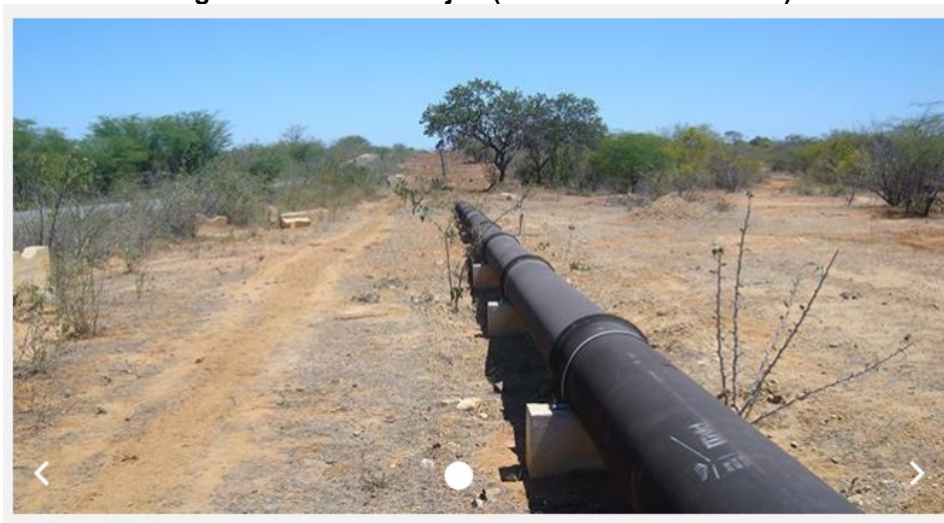
Figura 6 – Adutora Pajeú (de ferro fundido dúctil)
