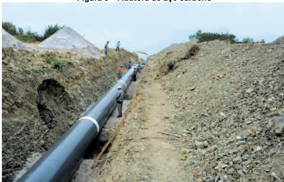
Figura 5 – Adutora de aço carbono
