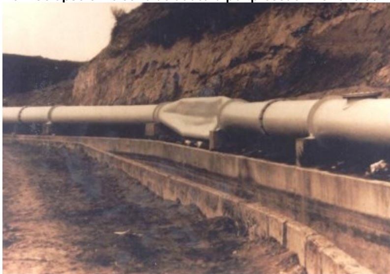
Figura 16 – Colapso em trecho de adutora por pressão inferior à atmosférica
