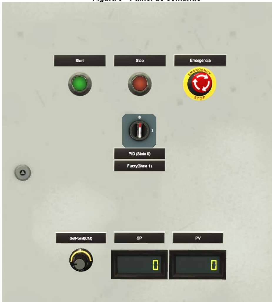
Figura 9 - Painel de comando
