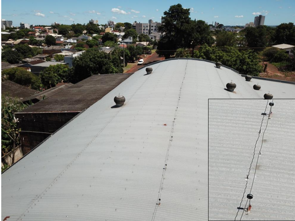
Imagem 6 – Cobertura do galpão com realce para o cabo da Gaiola de Faraday.
