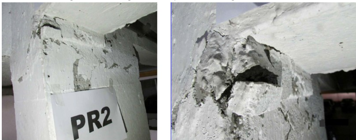
Figura 37 – Esmagamento do pilar PR2 no segundo subsolo
