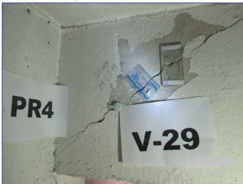
Figura 30 - Trinca de 2 mm a 45°
