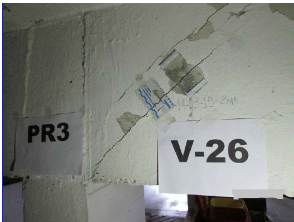
Figura 26 - Trinca a 45° em viga V26 com pilar PR3
