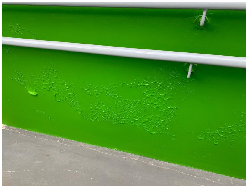
Fotografia 4 – Rampa 1 – Bolhas na pintura
