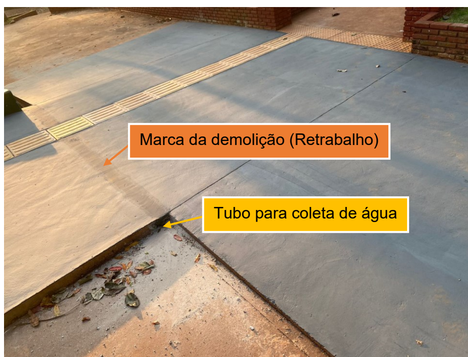
Fotografia 2 – Piso inclinado – entrada colégio
