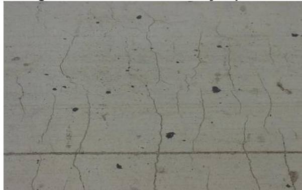
Figura 73 – Fissuras de retração plástica
