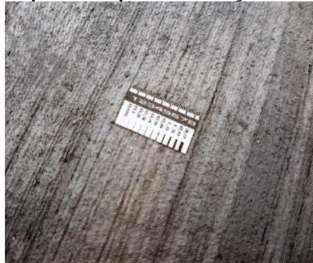
Figura 45 – Aspecto superficial após texturização com vassoura de piaçava
