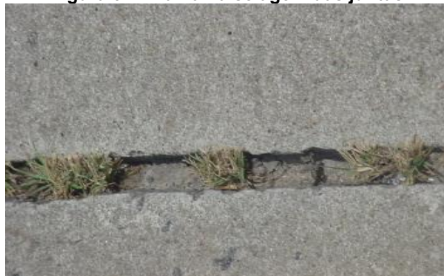
Figura 57 – Falha na selagem das juntas
