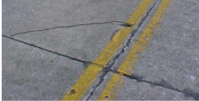
Figura 59 – Fissura de canto
