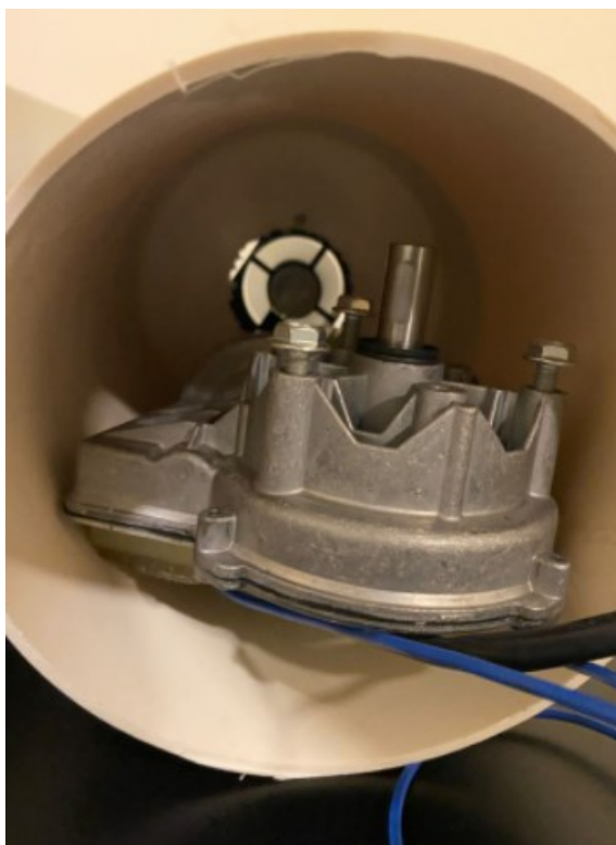
Figura 27 - Motor dentro do tubo com ventilação forçada.
