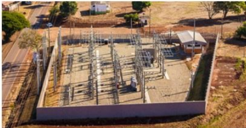
Figura 2 – Subestação de Santa Amélia, COPEL
