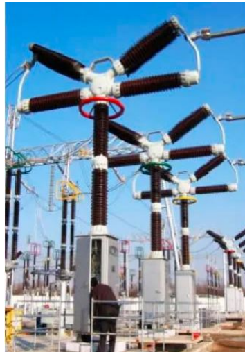
Figura 6 – Disjuntor isolado a gás SF 6
