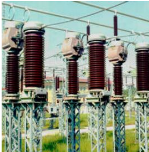
Figura 11 – Transformadores de potencial
