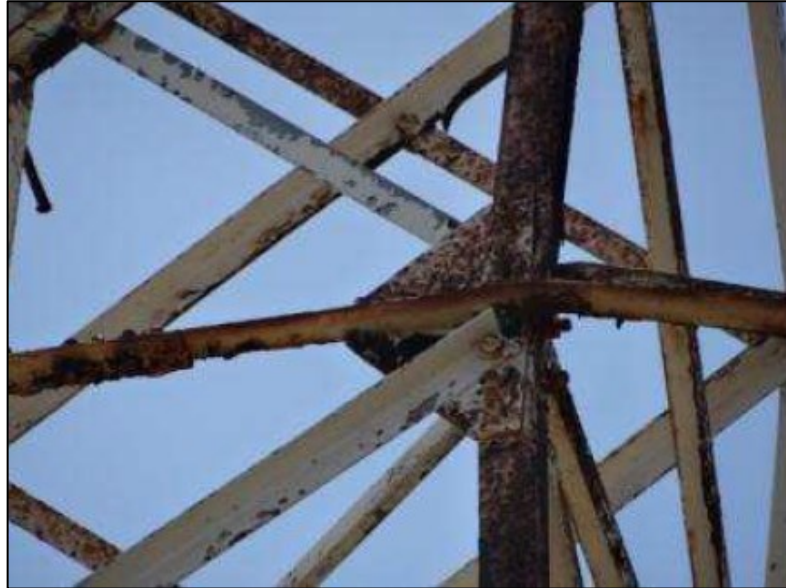
Figura 22 - Corrosão nas treliças da estrutura de sustentação
