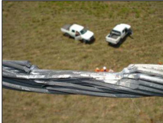
Figura 13 - Cabo danificado por espaçador
