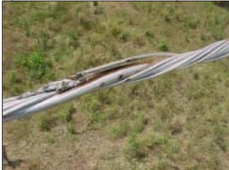
Figura 14 - Cabo OPGW danificado por descarga atmosférica
