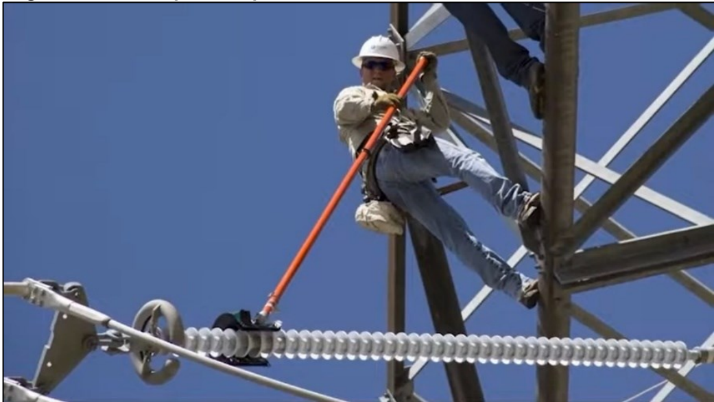
Figura 27 - Uso do positron para detecção de defeitos em cadeias de isoladores.
