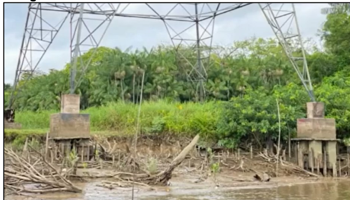
Figura 23 - Erosão em base de torre de transmissão
