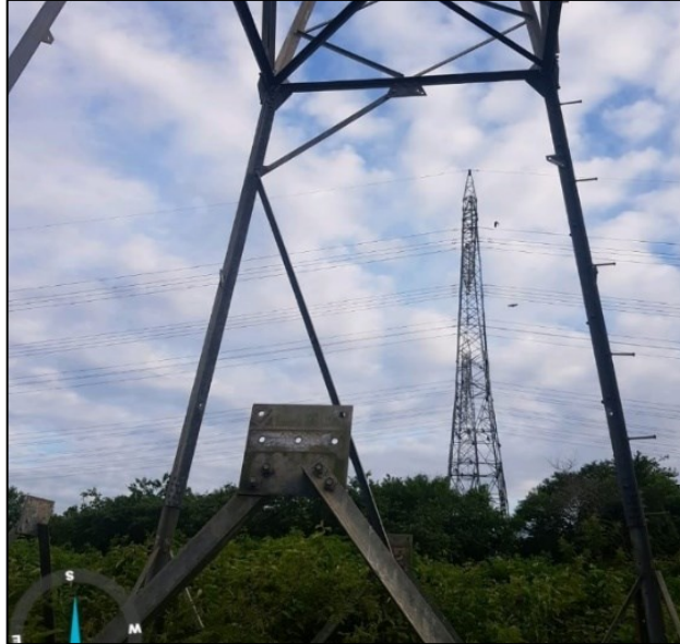
Figura 24 - Furto de peças metálicas da estrutura
