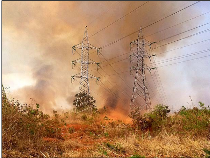
Figura 21 - Incêndio em faixa de servidão próximo a torres
