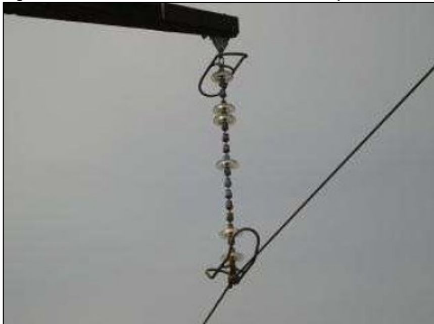
Figura 17- Cadeia de isoladores de vidro danificada por vandalismo
