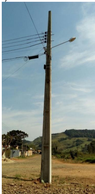
Figura 12: Poste de rede de transmissão Fonte: as autoras
