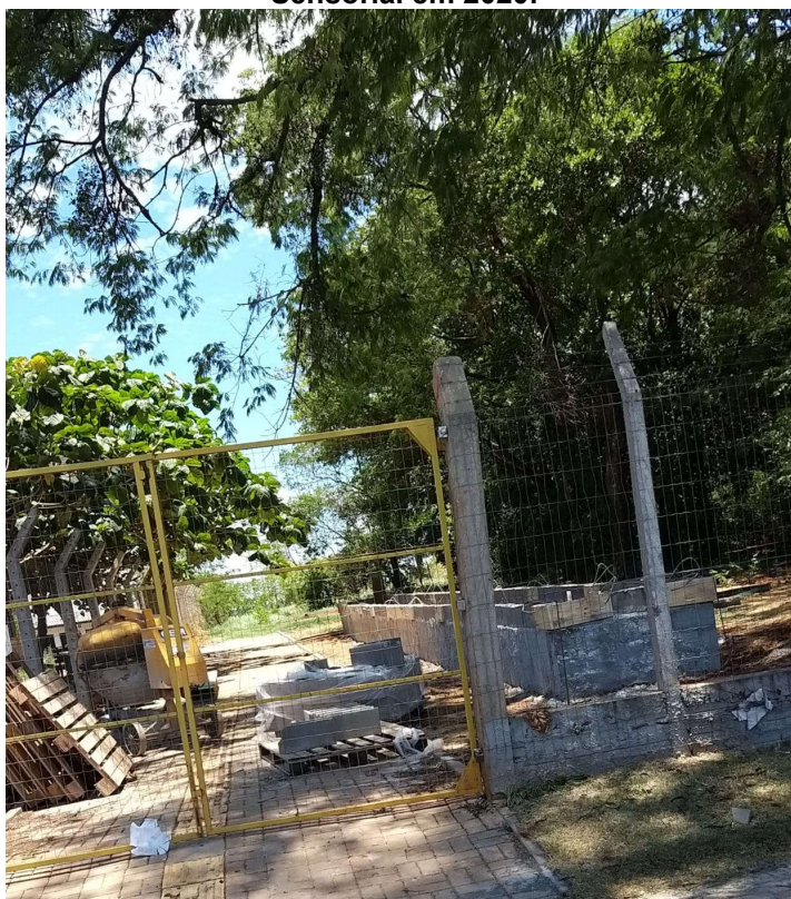
Fotografia 1 - Entrada do Bosque da UTFPR mostrando a construção do canteiro do Jardim Sensorial em 2020.
