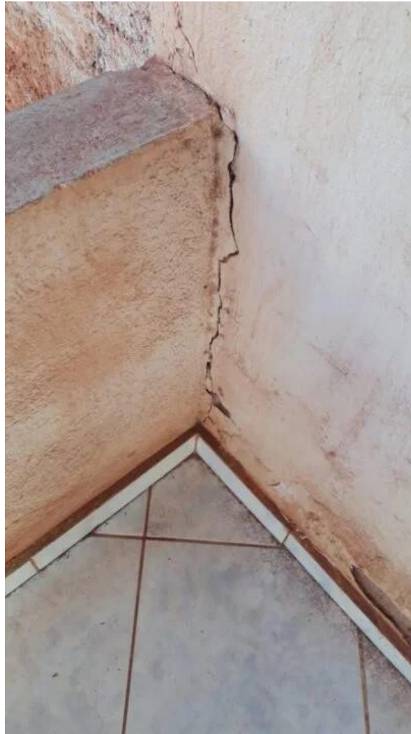
Figura 11 - Danos a Estrutura Residencial
