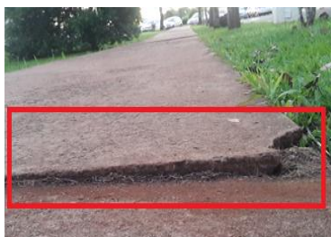
Figura 1: Desnível em Rota de Circulação de Pessoas
