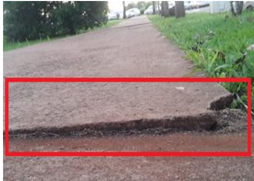
Figura 22: Desnível Constatado com Rota Acessível em Ambientes Externo
