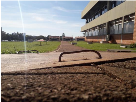
Figura 26: Caixa de Inspeção em Rota Acessível - Alça Irregular
