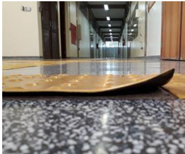
Figura 23: Piso Tátil com Defeito de Instalação
