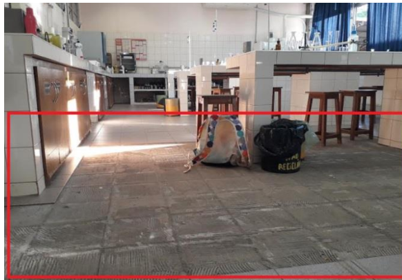
Figura 17: Piso sem Revestimento no Laboratório C106
