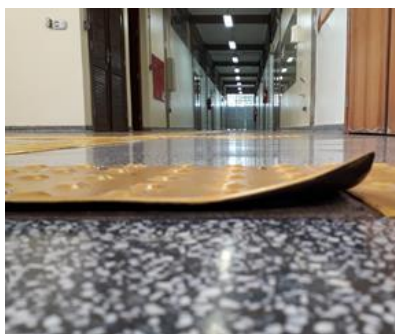
Figura 3: Piso Tátil com Defeito de Instalação
