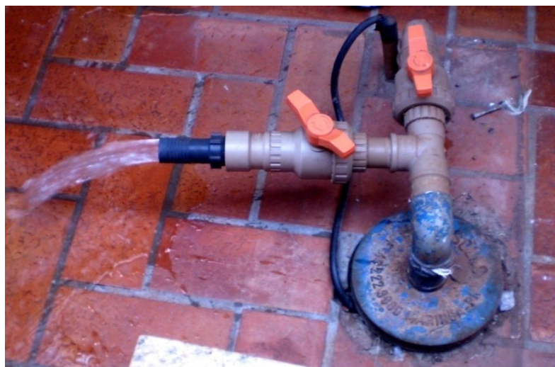
Figura 13 - Poço tubular profundo de captação da água subterrânea.
