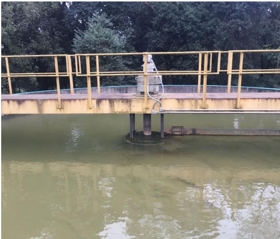
Figura 10 – Adensador da ETA
