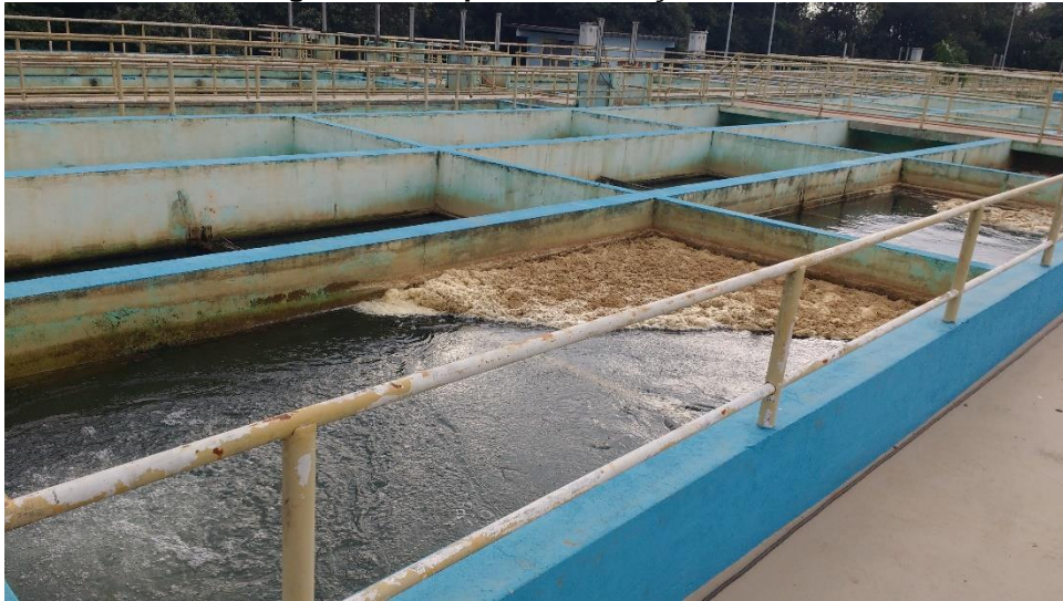
Figura 6 – Tanque de floculação da ETA
