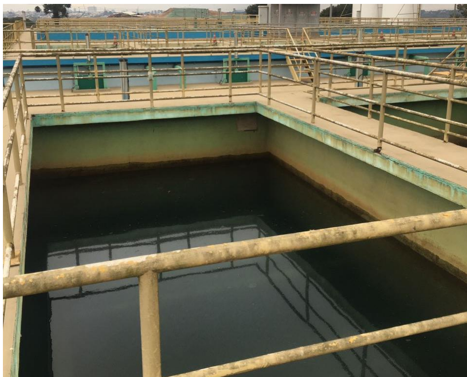
Figura 8 – Filtro na ETA
