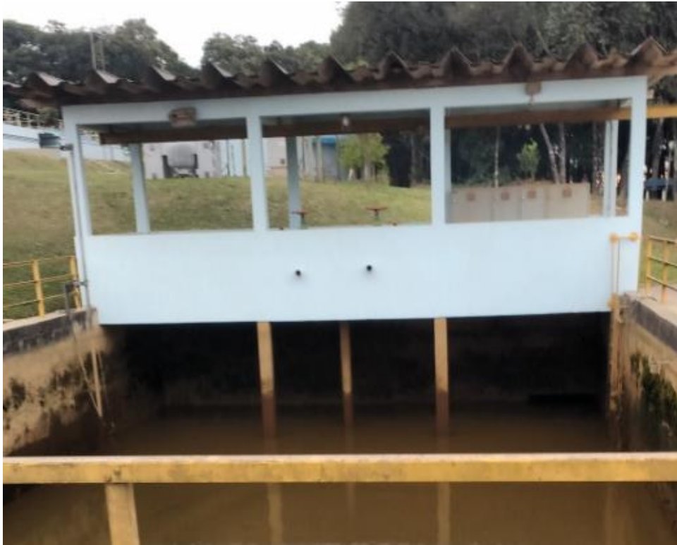
Figura 9 – Tanque de estabilização do lodo na ETA
