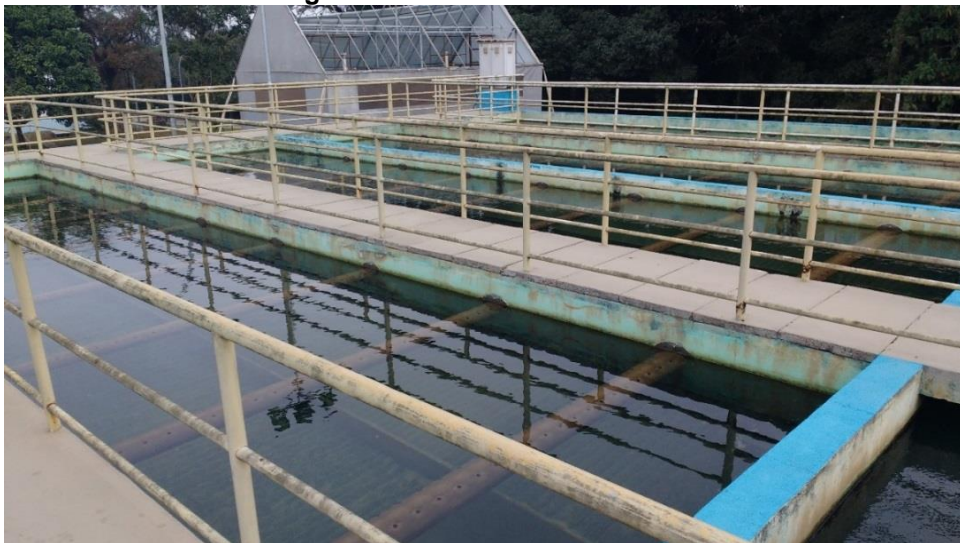
Figura 7 – Decantadores da ETA
