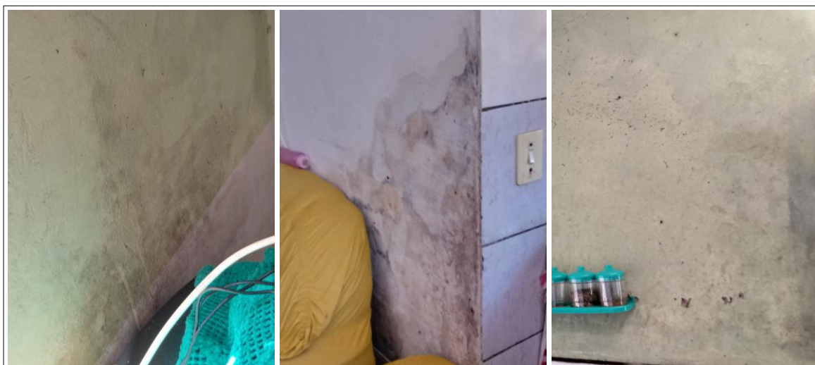
Figura 4.8 – Manchas de bolor na pintura interna
