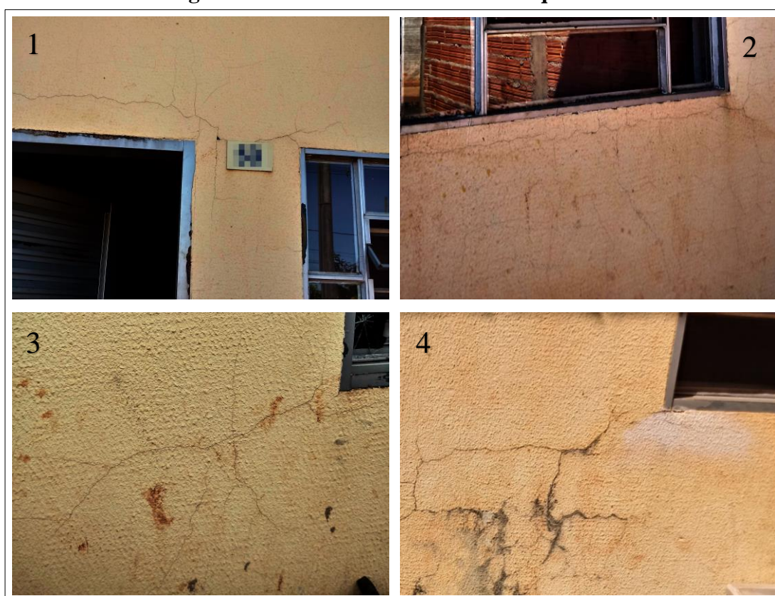
Figura 4.12 – Fissuras ao redor das esquadrias
