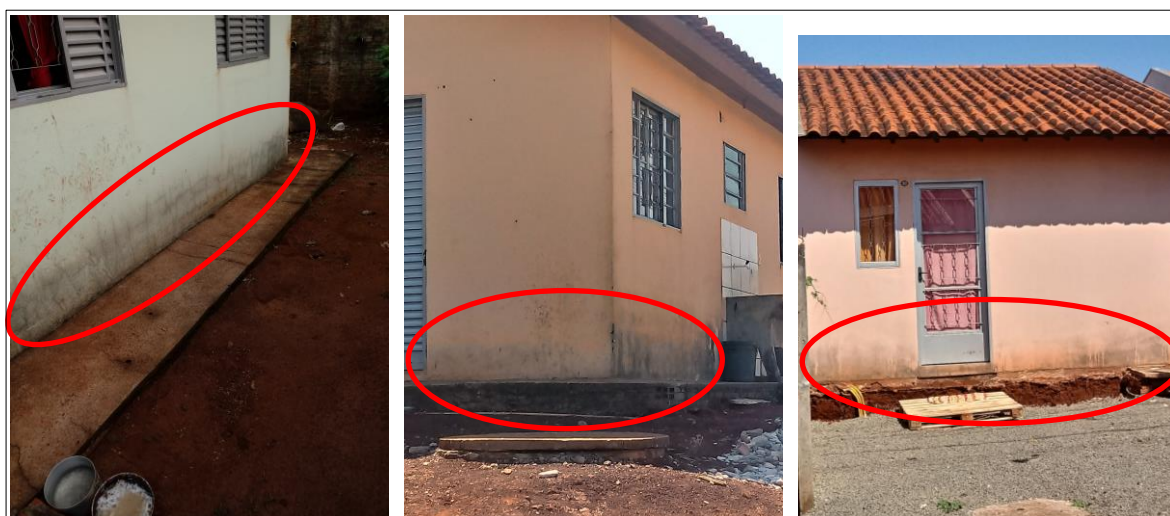
Figura 4.6 – Manchas de bolor localizadas próximo à infraestrutura
