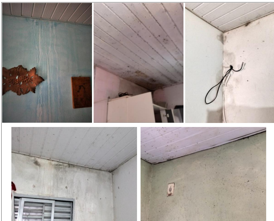
Figura 4.10 – Infiltração de água através da cobertura
