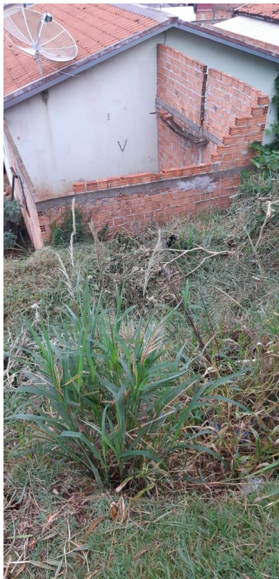
Figura 4.14 – Talude entre residências ameaçadas estruturalmente
