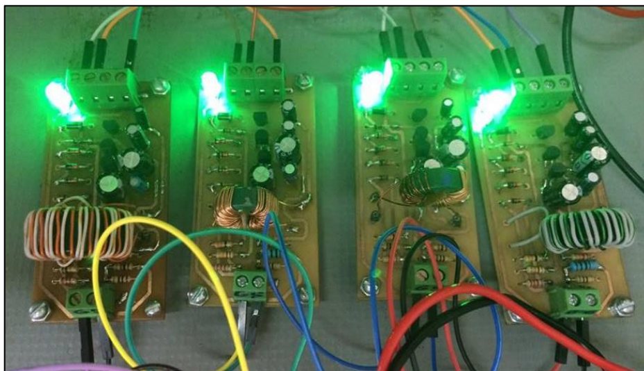
Figura 41: Circuitos drive energizados.
