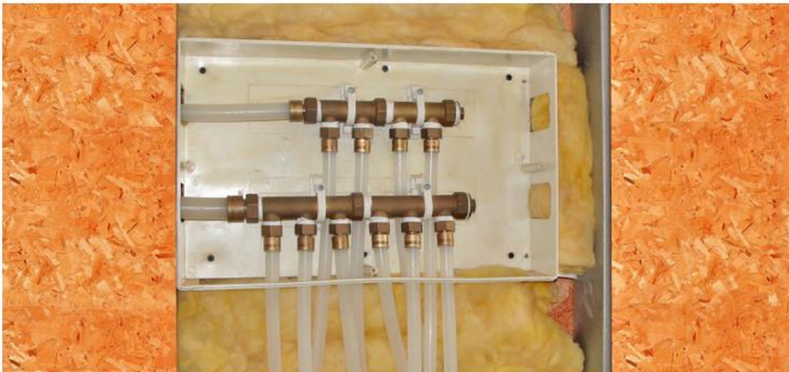
Figura 16 - Instalação Hidráulica em Light Steel Frame Fonte: Smart Sistemas Construtivos (2017).
