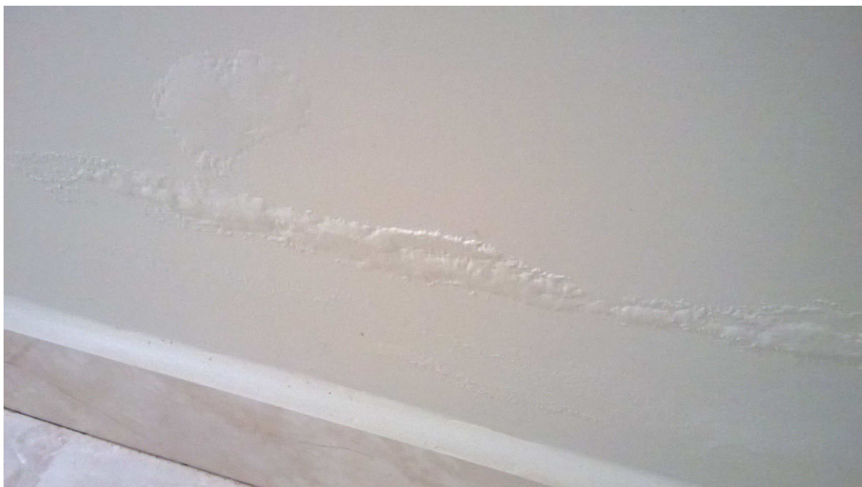
Fotografia 3 – Infiltração próxima ao piso em uma parede Fonte: Autoria própria
