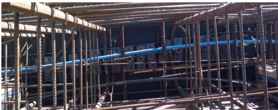
Figura 18 – Blocos de ancoragem ao fundo da figura desalinhados
