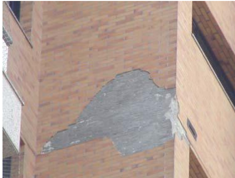
Figura 14 - Destacamento: erro de assentamento Fonte: Junginger (2007)
