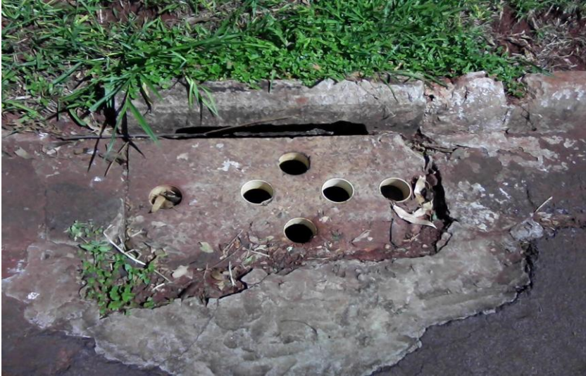
Fotografia 7: Boca de lobo Fonte: Autoria própria
