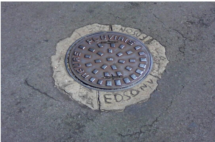
Fotografia 6: Poço de inspeção Fonte: Autoria própria
