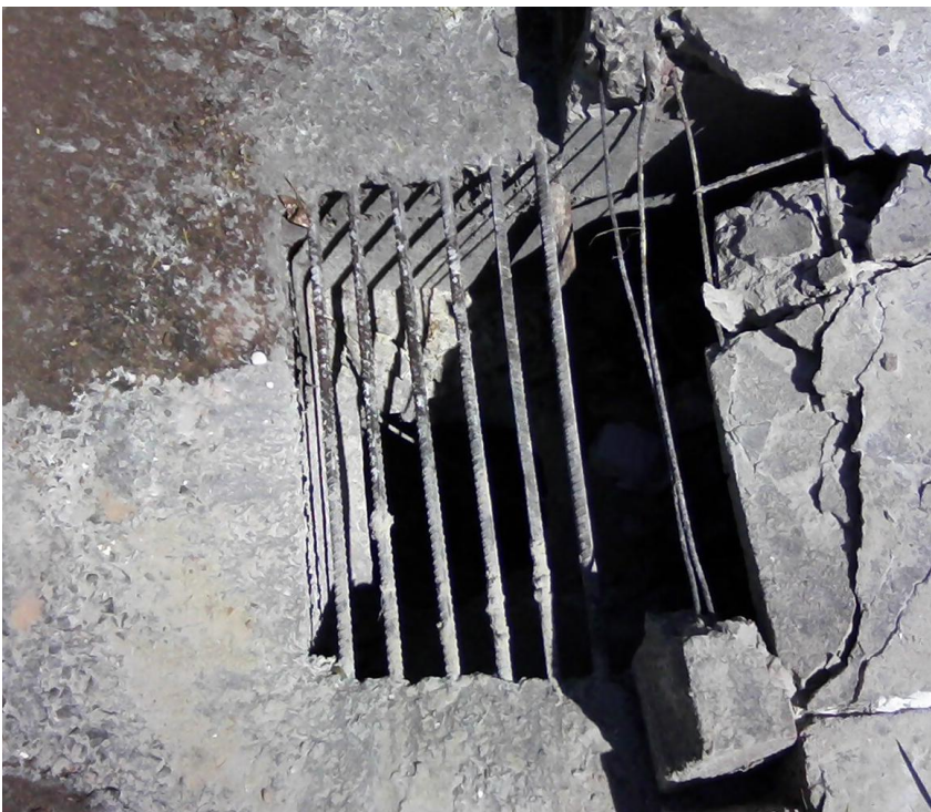
Fotografia 8: Boca de lobo Fonte: Autoria própria
