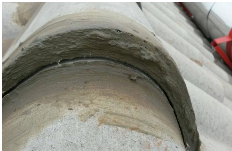
Figura 7 - Espaço entre as peças de concreto
