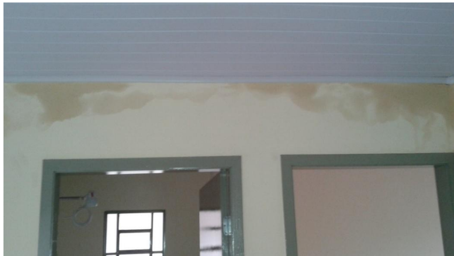
Figura 5 - Parede manchada pela infiltração de água da chuva pela cumeeira
