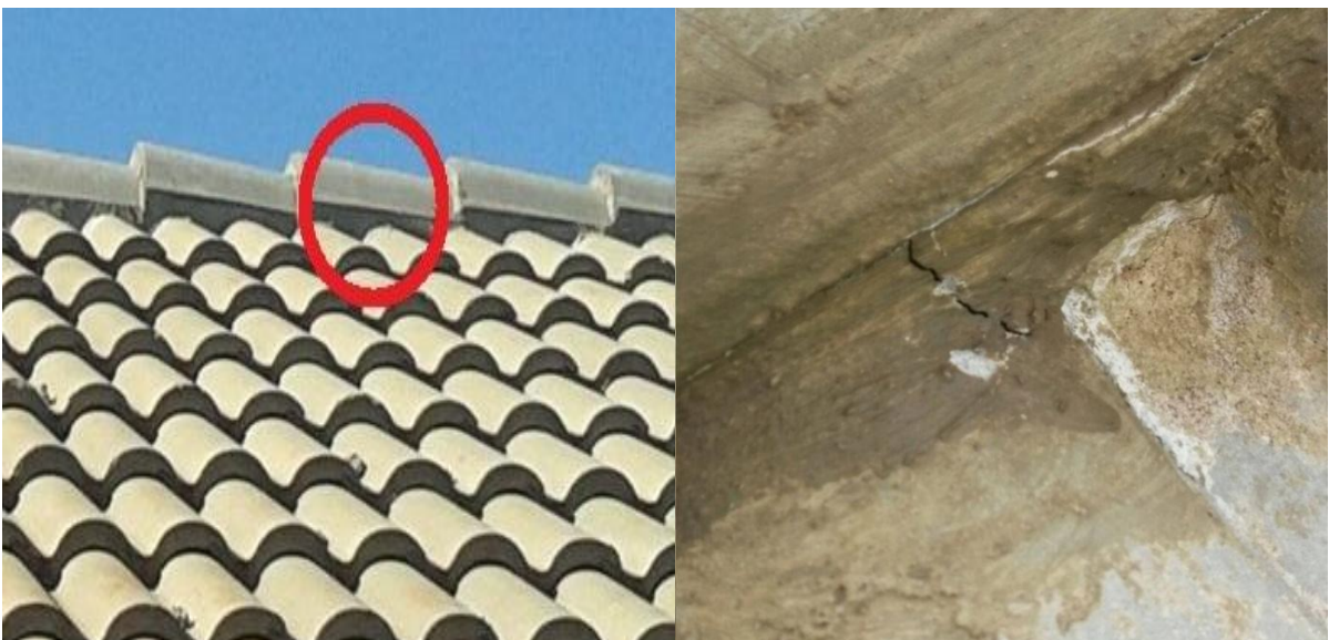
Figura 6 - Fissura e falhas de aderência na argamassa aplicada lateralmente na cumeeira (à direita) e a localização do problema destacado em vermelho (à esquerda).
