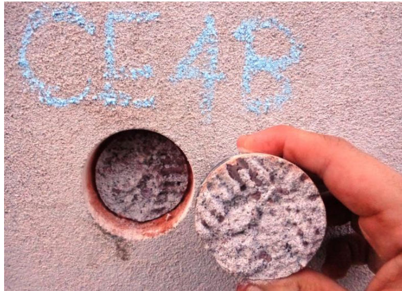
Figura 42 - Forma de ruptura chapisco/revestimento
