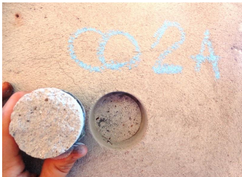
Figura 41 - Superfície de ruptura na camada de chapisco/revestimento
