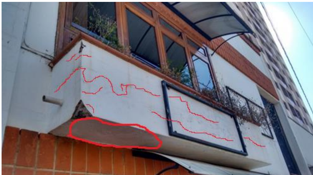
Figura 49 - Floreira com bolhas na pintura, trinca e descolamento de reboco
