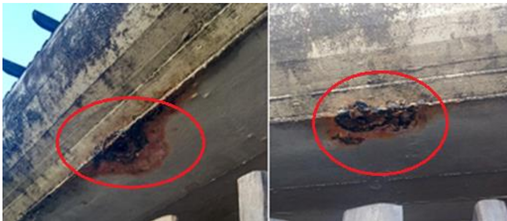
Figura 44 - Floreira com patologia no dreno e na pintura
