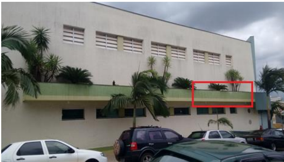
Figura 47 - Desprendimentos de pastilhas com o aparecimento de eflorescência
