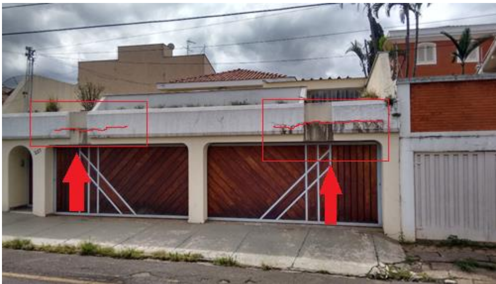
Figura 46 - Trinca entre a laje e a alvenaria
