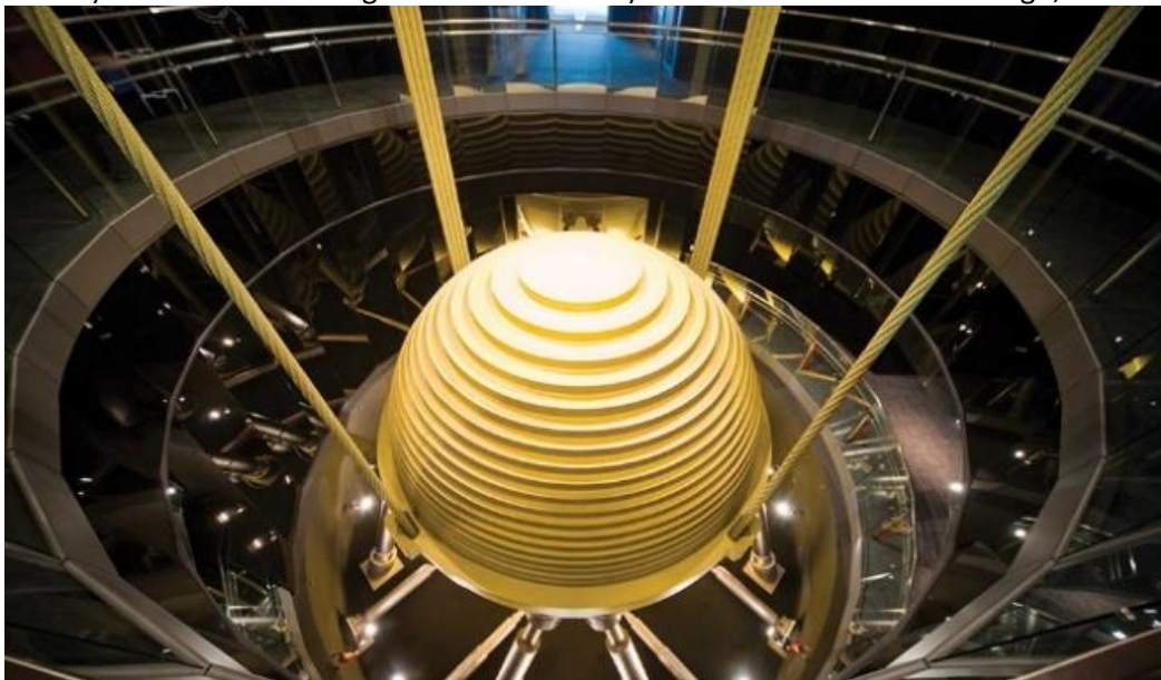
c) Amortecedor de massa sintonizada utilizada no edifício Taipei 101.
