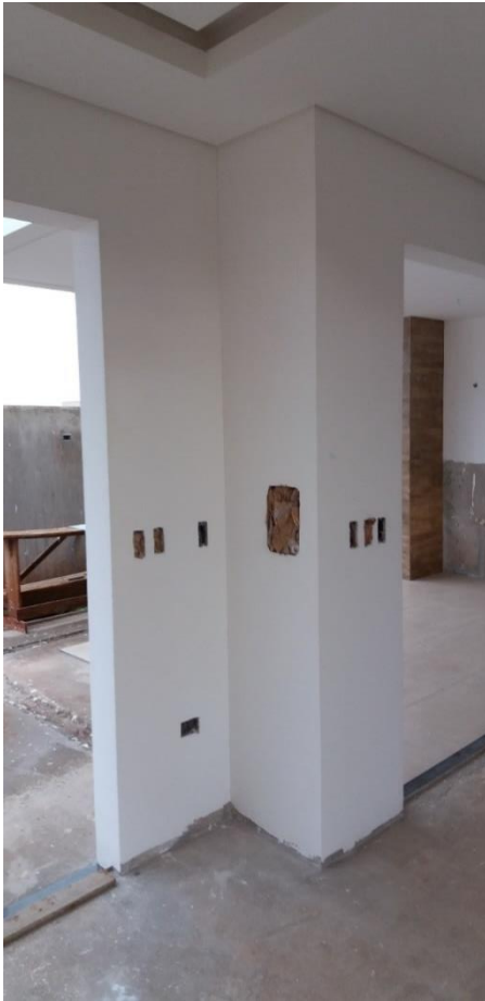
Fotografia 12 – Detalhe dos interruptores Fonte: Acervo de fotografias da obra.
