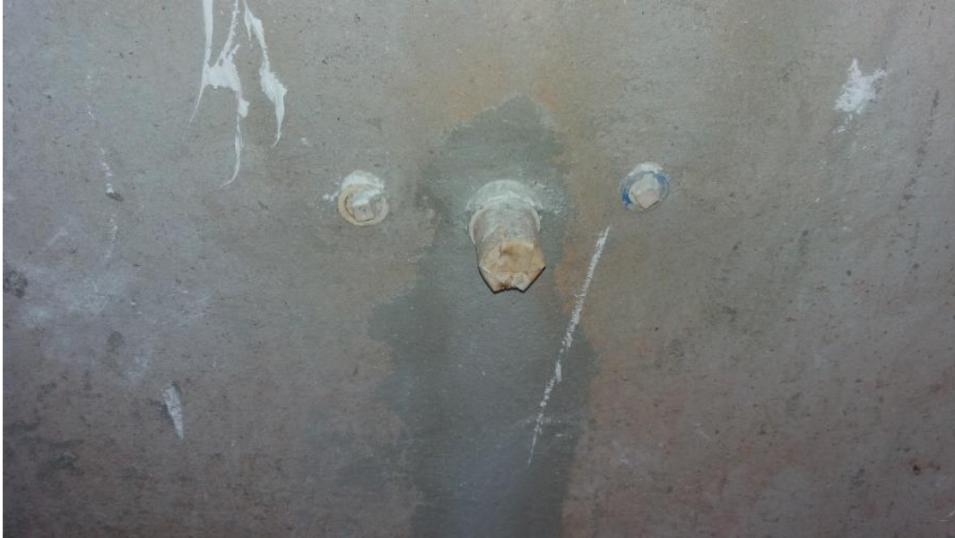
Fotografia 7 – Detalhe da tubulação de água da área de lazer Fonte: Acervo de fotografias da obra.
