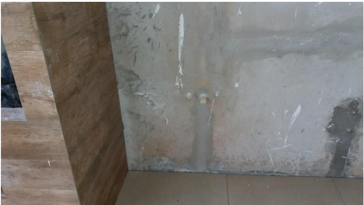
Fotografia 6 – Tubulação de água da área de lazer Fonte: Acervo de fotografias da obra.
