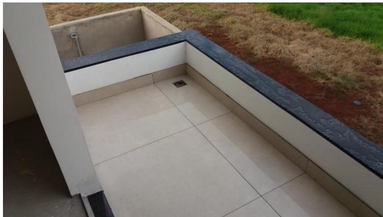
Fotografia 2 – Detalhe da alteração do ralo da sacada Fonte: Acervo de fotografias da obra
