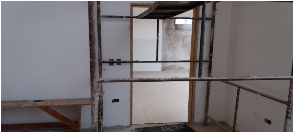
Fotografia 8 – Detalhes do pilar P16 e redução nas dimensões da porta Fonte: Acervo de fotografias da obra.
