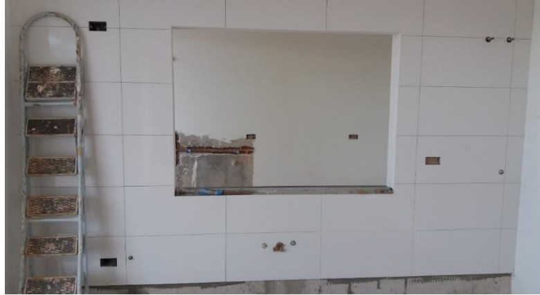
Fotografia 5 – Tubulação de água quente e fria da cozinha Fonte: Acervo de fotografias da obra.
