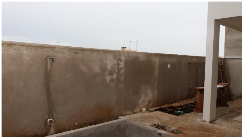
Fotografia 11 – Detalhes dos pontos de iluminação do muro dos fundos Fonte: Acervo de fotografias da obra.
