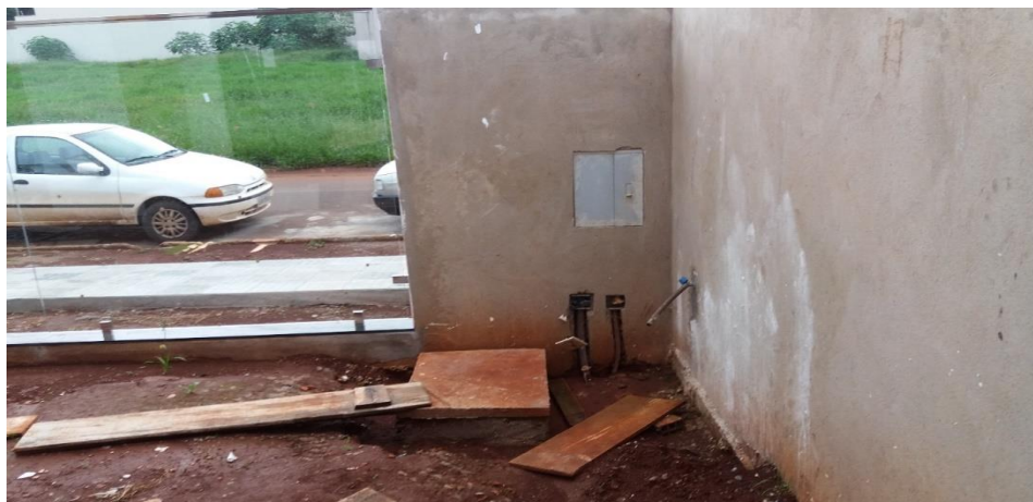
Fotografia 21 – Entrada de água da Sanepar Fonte: Acervo de fotografias da obra.
