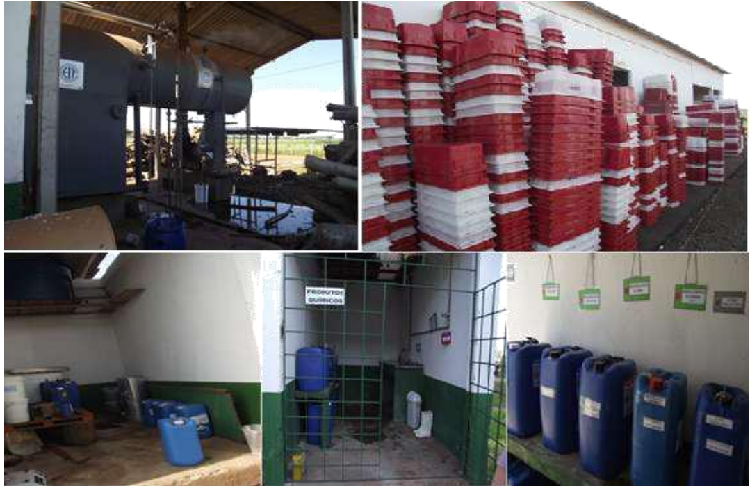
Figura 12. Caldeira, sala de lavagem de caixas e produtos químicos.
