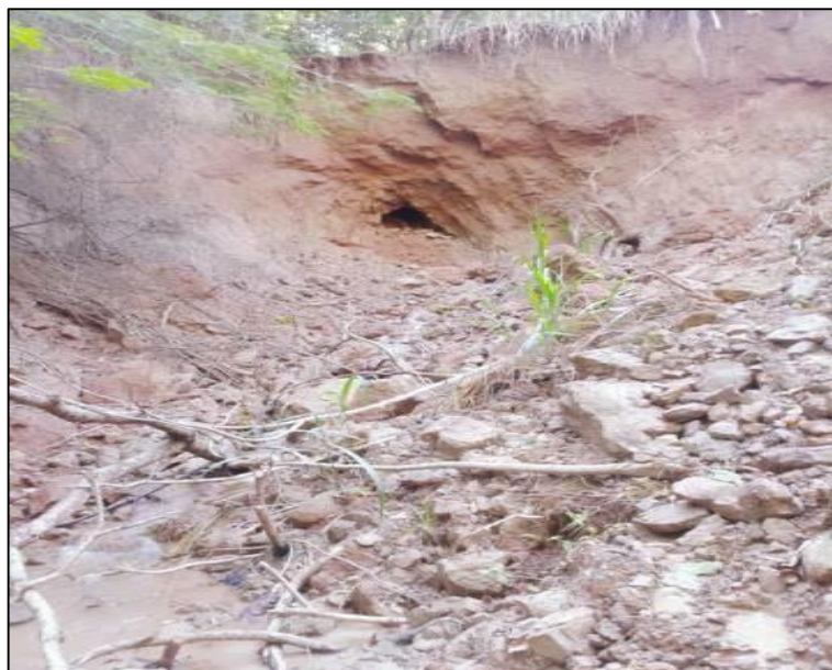
Figura 3 - Voçoroca com possível erosão em piping no parque em Goioerê - PR.
