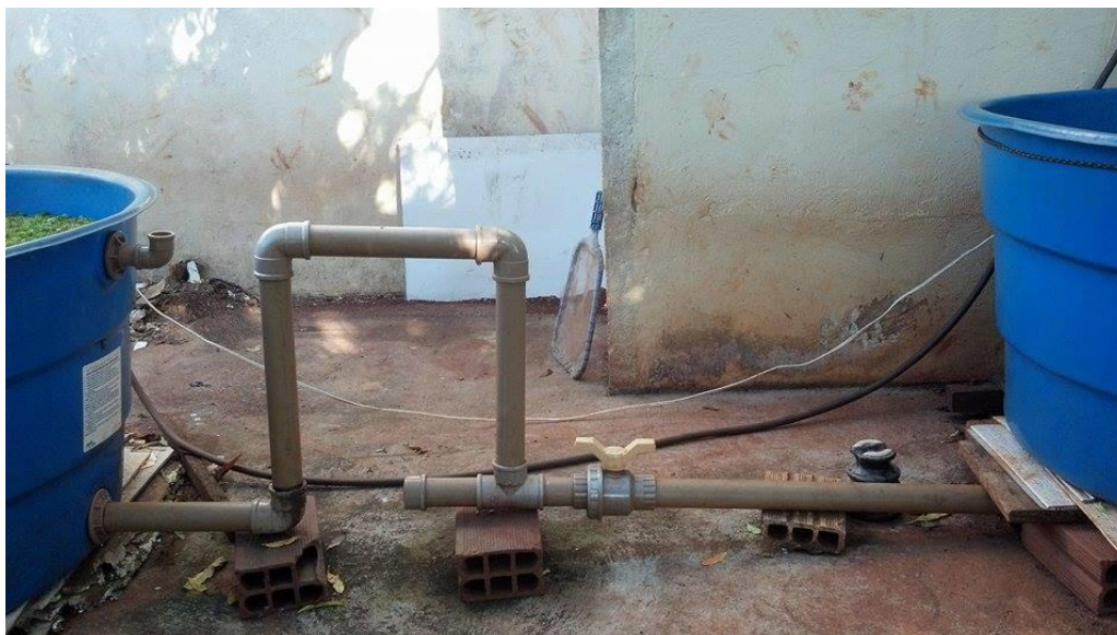
Figura 4 – Foto do sistema adutor. Ao centro: válvula removível (limpeza dos canos adutores).
