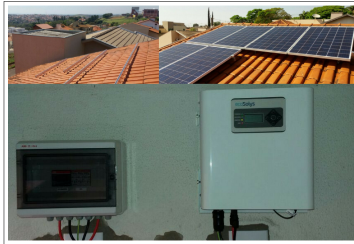
Figura 30: Projeto instalado na cidade de Cornélio Procópio.
