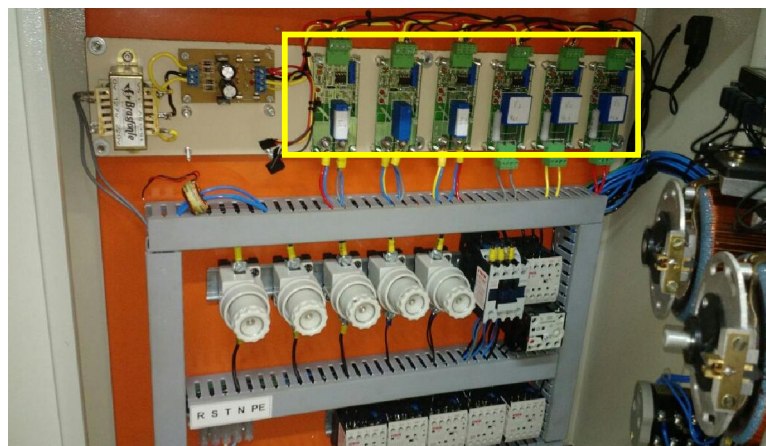
Figura 11. Sensores Hall de corrente e Tensão
