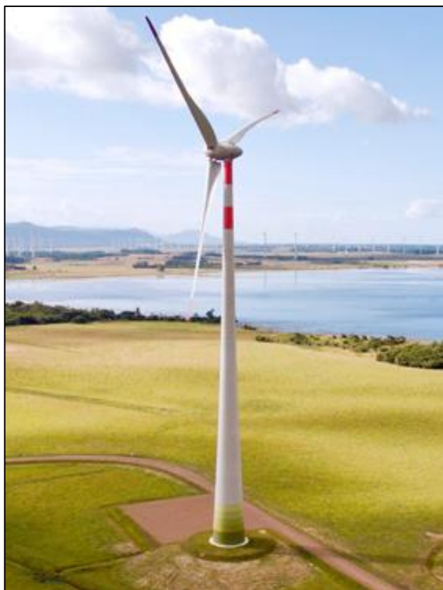
Figura 12 - Foto do Aerogerador E-92 Fonte: ENERCON
