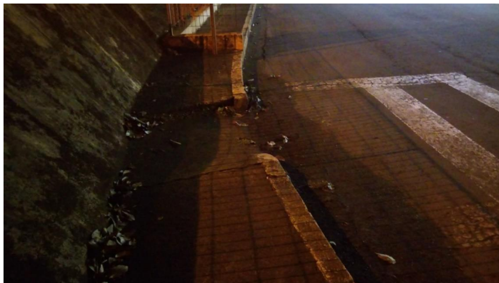
Figura 13: Rampas de meio fio em estado de abandono.
