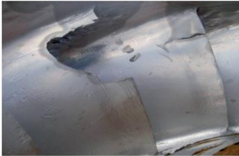
Figura 2 - erosão da região externa da turbina na planta de energia de Cahaua
