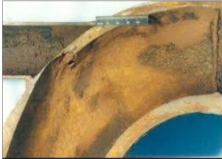
Figura 2 - Tubulação que sofreu corrosão - erosão.
